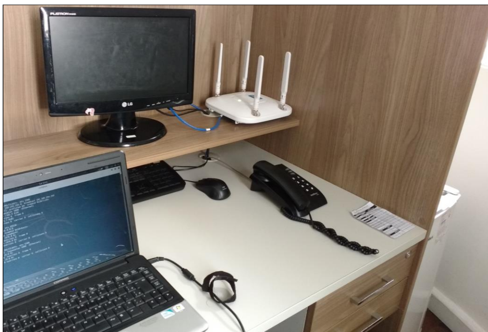
Figura 7: Local de instalação do Ponto de Acesso Cisco Fonte: Autoria própria, 2017
