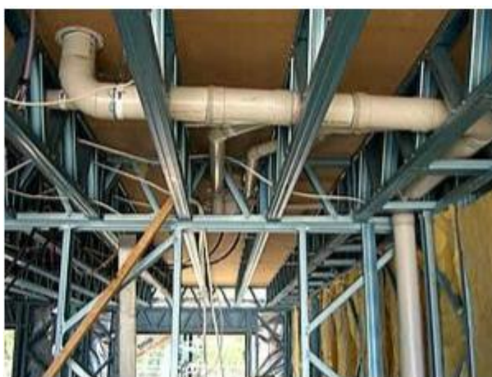
Figura 8 – Tubulações no Sistema Light Steel Frame Fonte: Metálica, 2016
