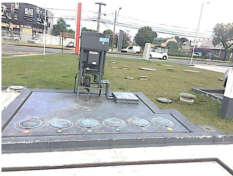
Figura 6 – Detalhe Tanques de Abastecimento Subterrâneo
