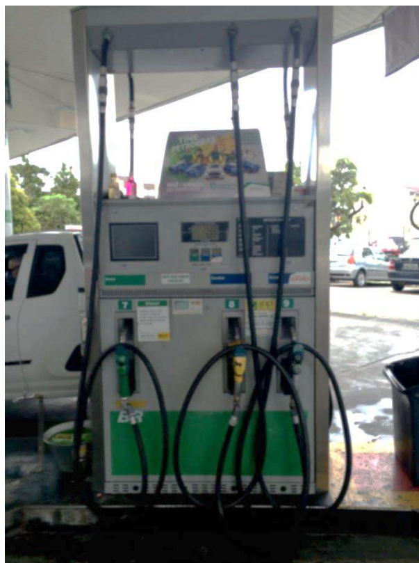
Figura 15 – Bombas de Abastecimento
