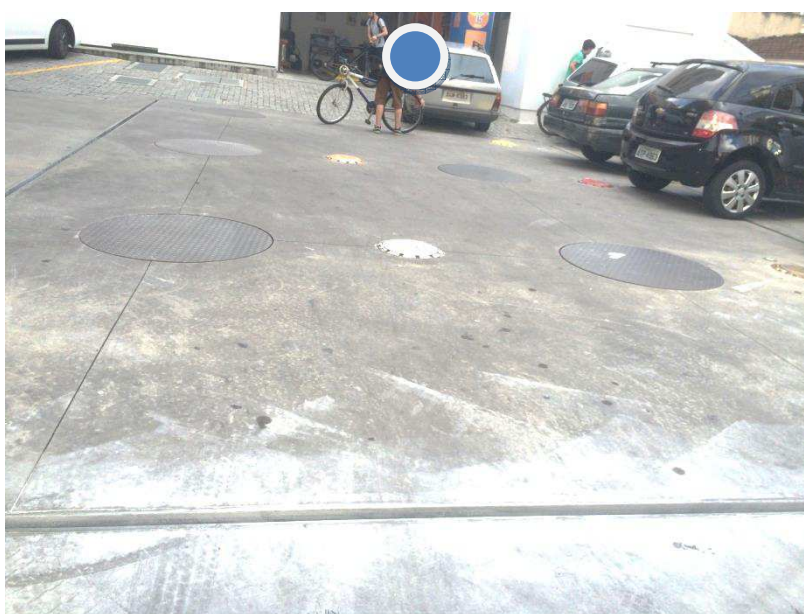
Figura 10 – Detalhe Tanques de Abastecimento Subterrâneo
