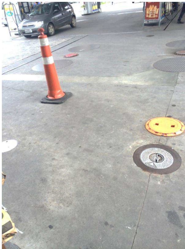
Figura 17 – Detalhe Tanques de Abastecimento subterrâneo
