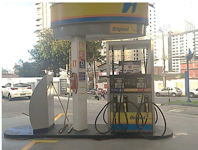
Figura 11 – Bombas de Abastecimento
