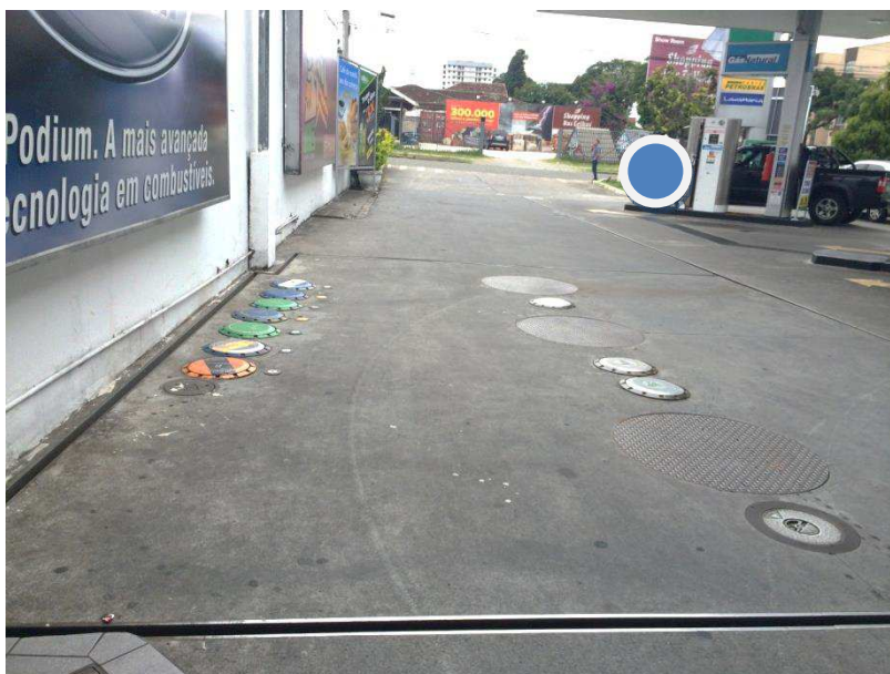
Figura 14 – Detalhe Tanques de Abastecimento Subterrâneo.
