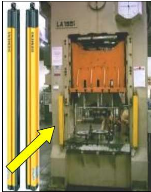
Figura 9 – Cortina de luz instalada
