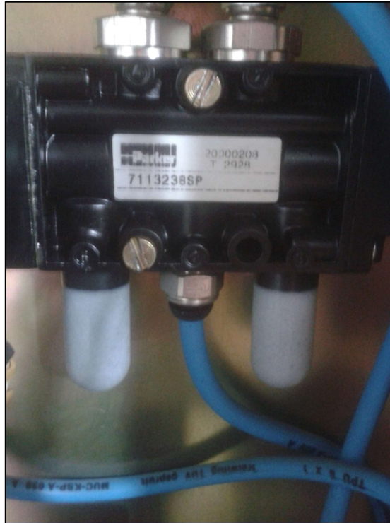
Figura 22 – Válvula pneumática utilizada na máquina não atende à NR-12
