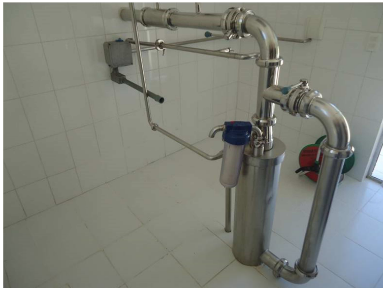
Figura 2 – Tubulação de revestimento do poço e linha de adução de fonte de água mineral localizadas dentro da casa de proteção da captação. Fonte: Acervo do Autor.
