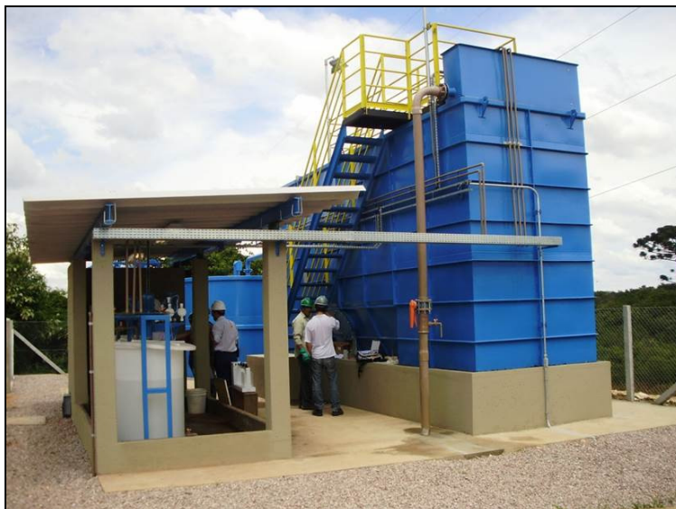
Fotografia 1 – Estação de Tratamento de Água Fonte: Autora (2016)
