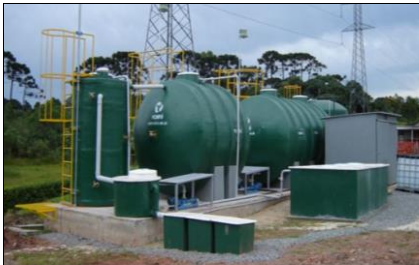
Fotografia 3 – Estação de Tratamento de Efluente Fonte: Autora (2016)
