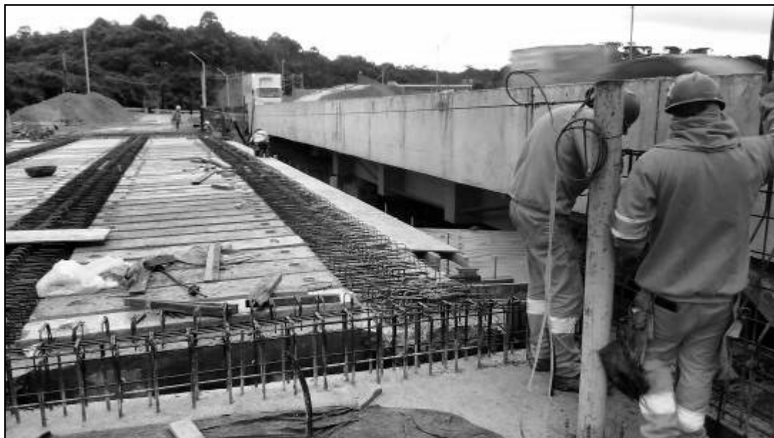
Figura 27 – Detalhe ponto de ancoragem e linha de vida horizontal Fonte: O autor, 2017
