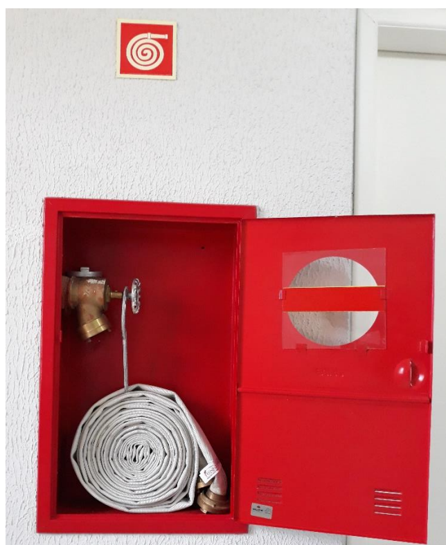
Figura 19 – Hidrante de Parede
