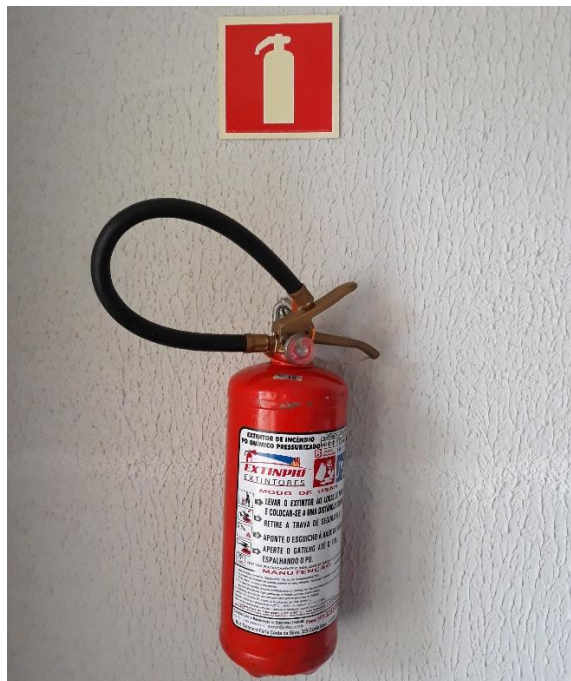
Figura 18 – Extintor de Incêndio Pó-Químico Classe BC Fonte: O Autor (2018)
