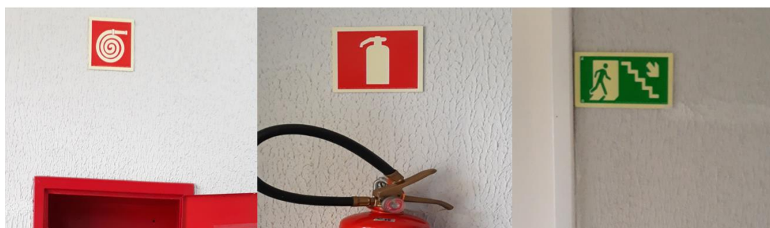
Figura 17 – Sinalização de Emergência Fonte: O Autor (2018)
