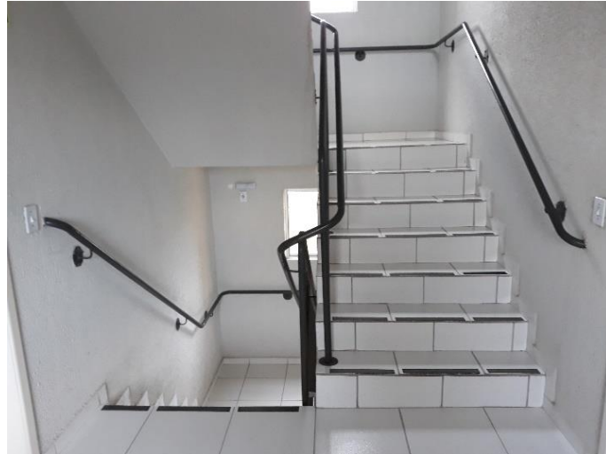
Figura 13 – Largura do Acesso/Escada Fonte: O Autor (2018)
