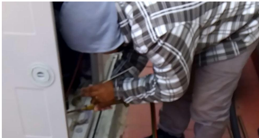
Figura 13 - Solda na conexão da tubulação com o equipamento
