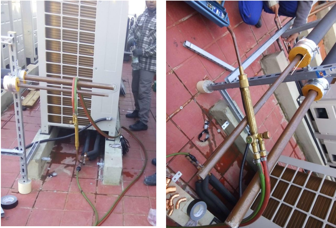
Figura 19 - Maçarico utilizado pelo soldador “B” sem suporte apropriado
