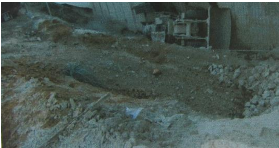
Figura 4- Pá carregadeira tombada
