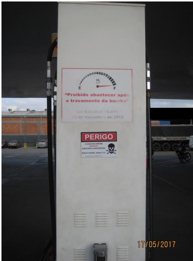
Figura 13 – Placa indicativa de perigo. Fonte: Autor (2017).
