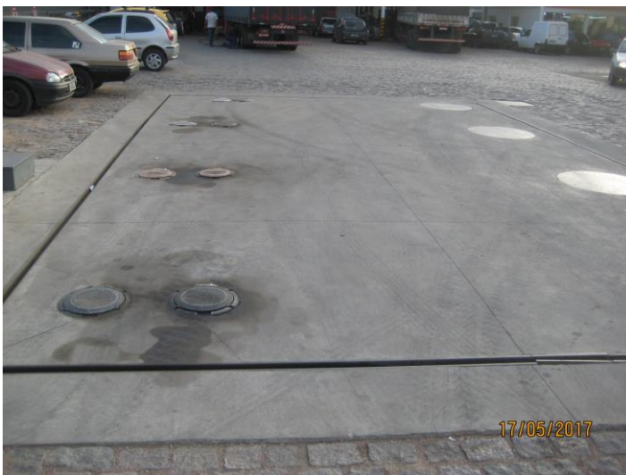
Figura 14 – Área de descarga de combustíveis. Fonte: Autor (2017).
