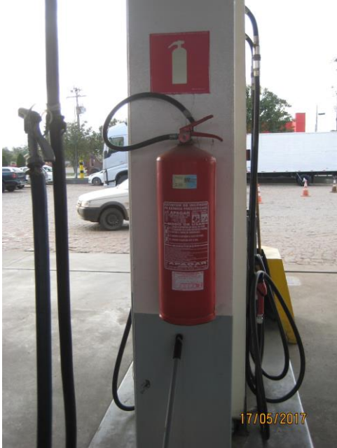
Figura 11 – Extintor de incêndio. Fonte: Autor (2017).
