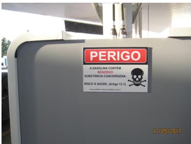
Figura 12 – Placa indicativa de perigo. Fonte: Autor (2017).
