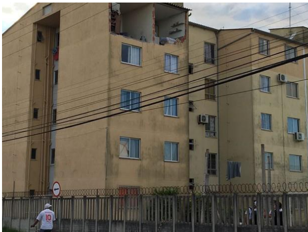
Figura 6 – Acidente por vazamento de gás.
