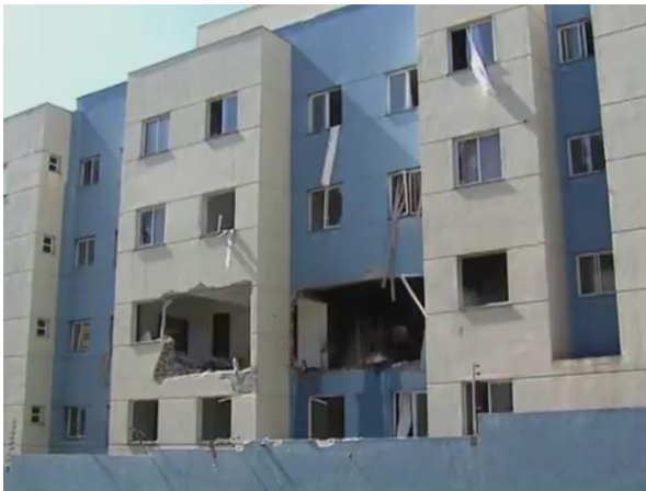
Figura 7 – Explosão por vazamento de gás.
