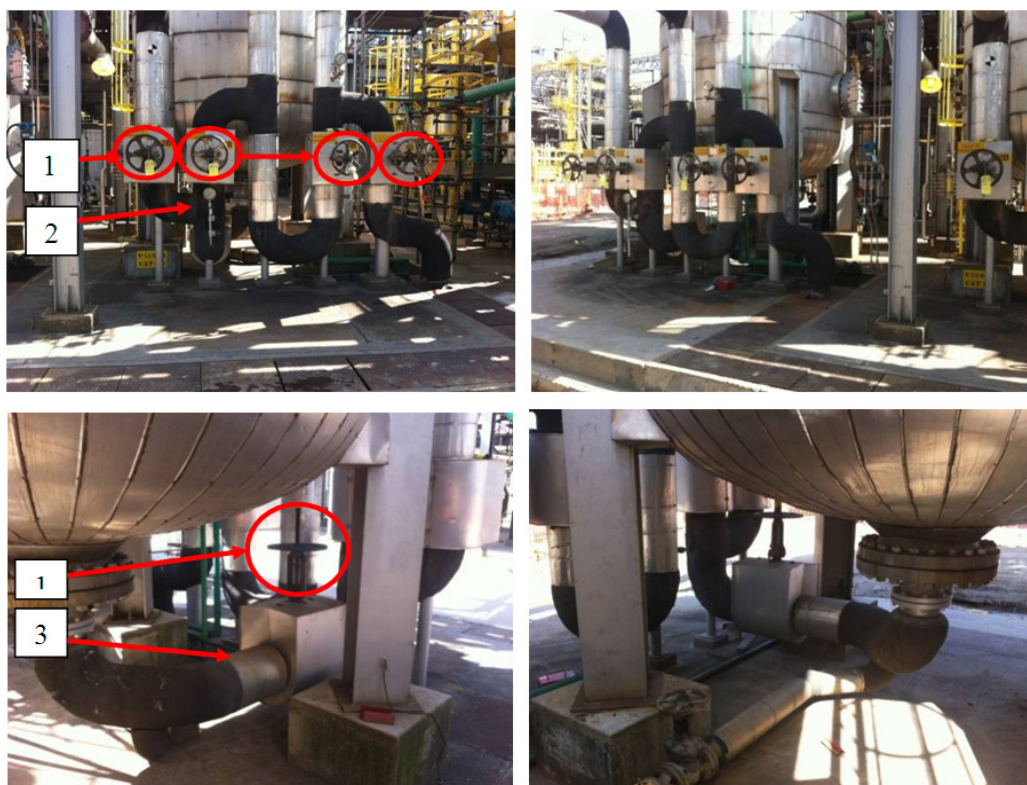
Figura 8 – Fotos do local de operação das válvulas Fonte: Autor, 2013
