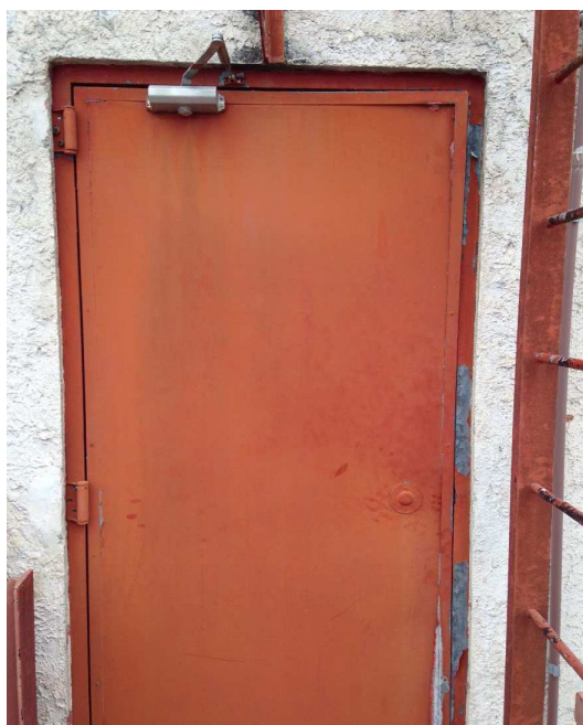
Figura 10: Porta corta-fogo P90 na saída para a Escada de Incêndio Fonte: Autor (2015)
