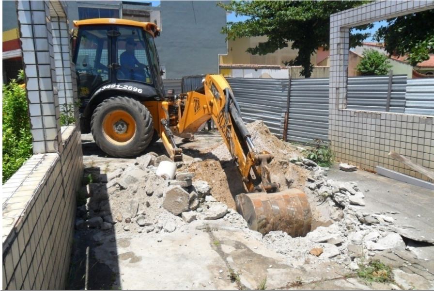
Figura 05 – Quebra de piso de concreto
