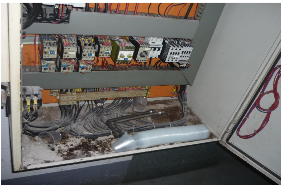
Figura 10 - Quadro de comando máquina NET. Fonte: próprio autor
