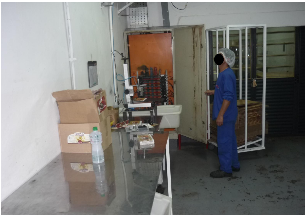
Figura 15 - Painel elétrico de baixa tensão. Fonte: Próprio autor
