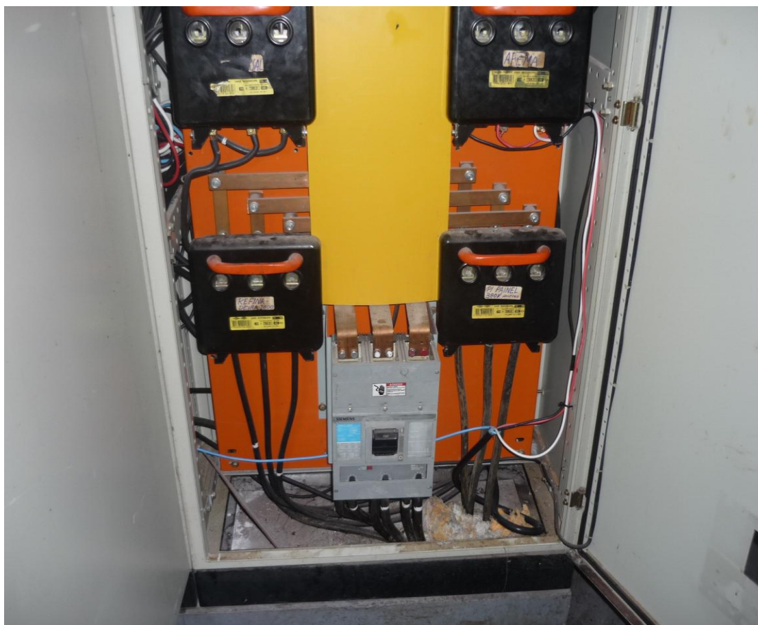
Figura 7 - Painel de distribuição.
