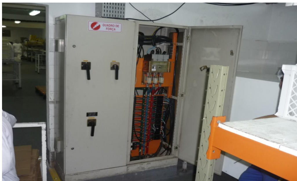
Figura 13 - Painel de alimentação tuneis refrigeração. Fonte: próprio autor.
