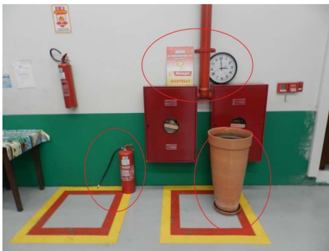
Figura 17: Não respeito das áreas demarcadas.
