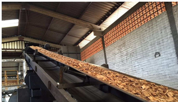
Figura 6 – Esteira de cavaco para abastecimento da caldeira
