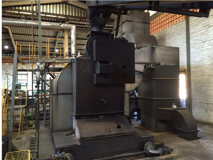
Figura 7 – Vista lateral da caldeira
