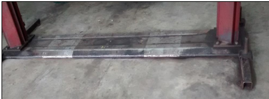
Figura 17: Caixa de óleo do elevador.
