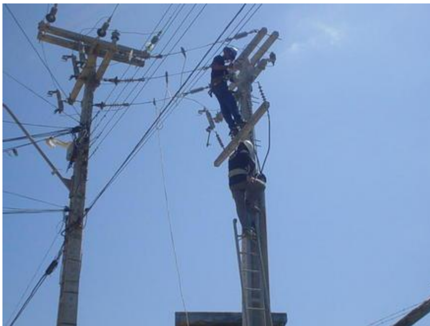
Figura 7: Combinação de trabalho em altura e serviço com eletricidade
