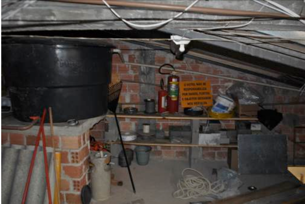
Figura 23 – Equipamentos de Agentes Extintores mal localizados.
