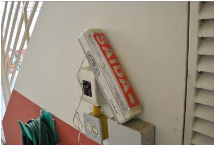
Figura 16 – Iluminação de Emergência em desuso
