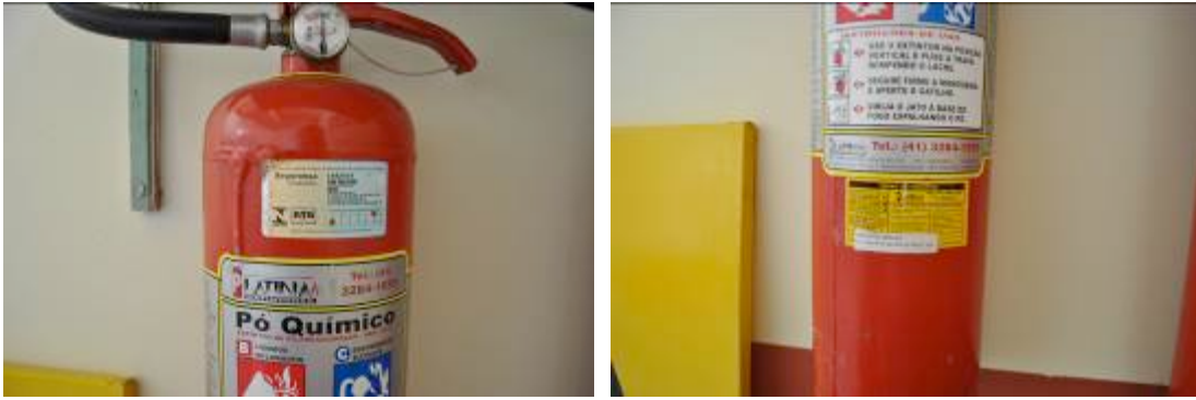
Figura 26 – Selo do INMETRO e Quadro de Instruções de Agentes Extintores
