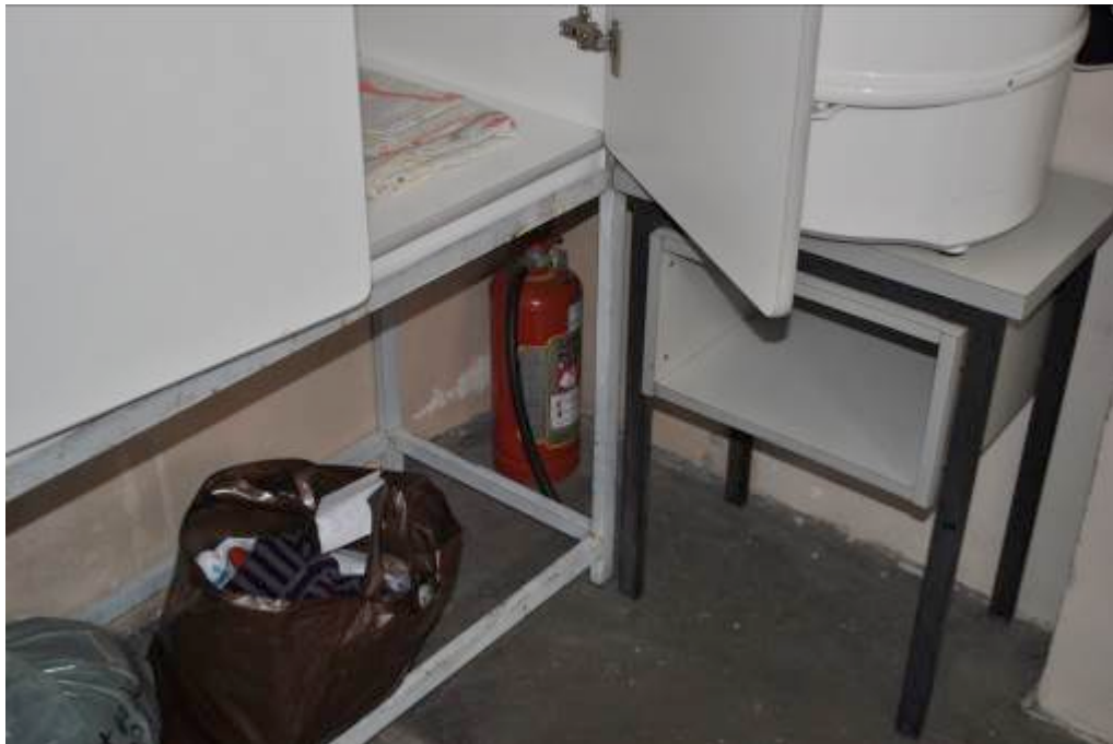
Figura 24 – Equipamentos de Agentes Extintores mal localizados.
