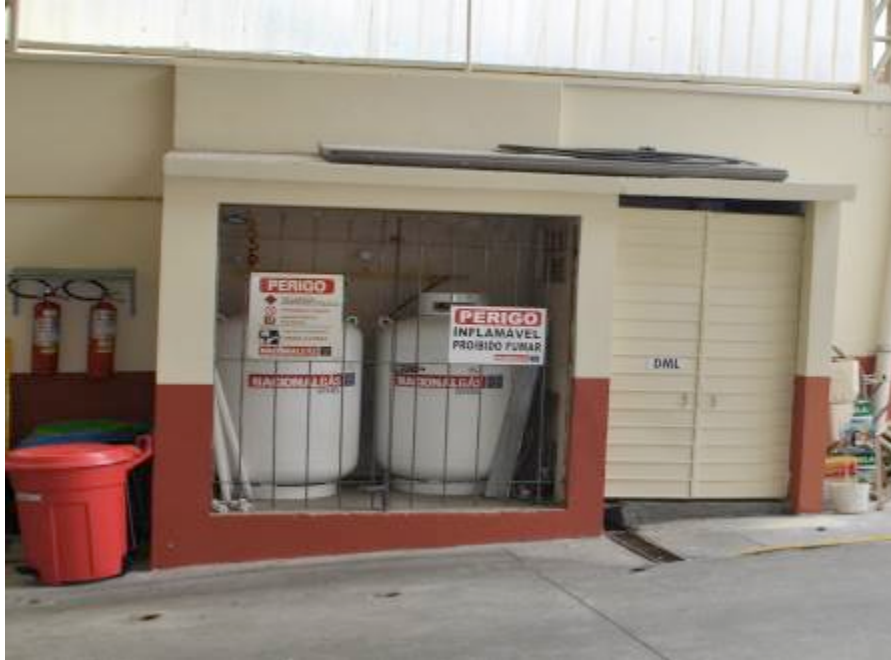
Figura 18 – Sinalização de Alerta de Perigo
