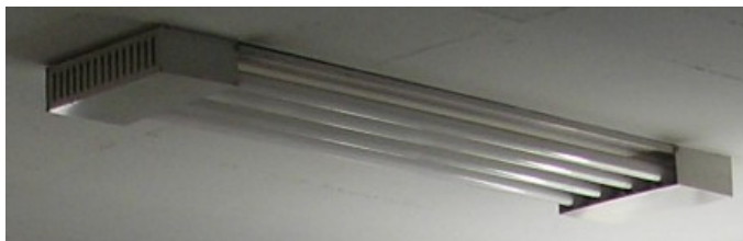
Figura 7 – Luminária Plafonier tipo BB com quatro lâmpadas fluorescentes de 40W.
