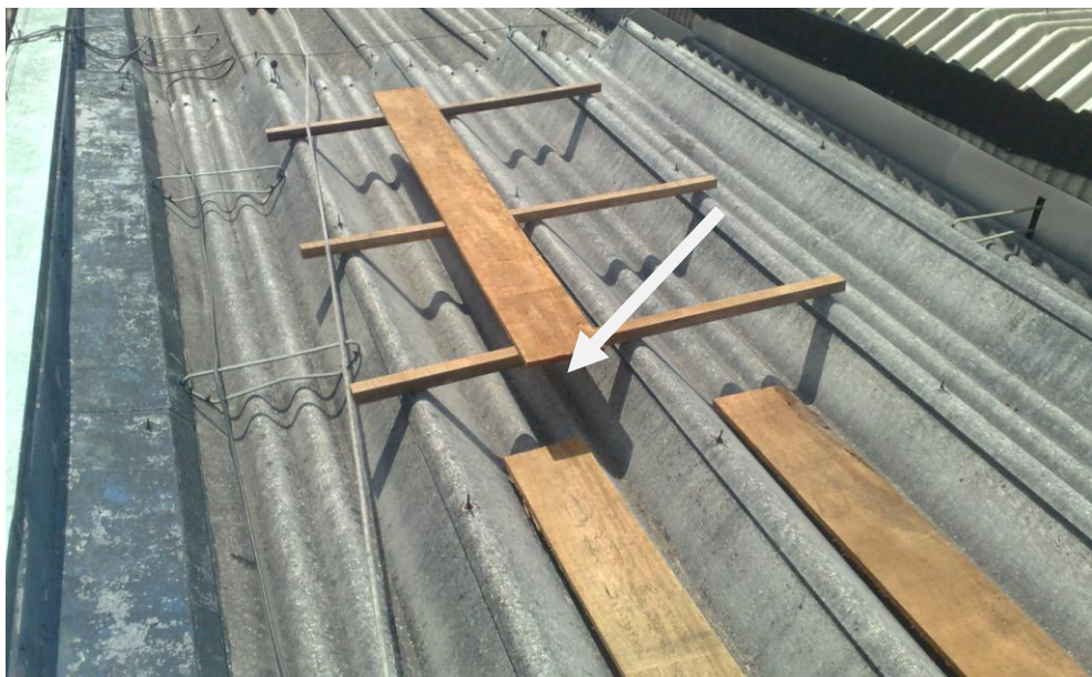
Figura 27: Utilização de tábuas de madeira para evitar a quebra das telhas (identificada pela seta). (FIRETTI, 2012)
