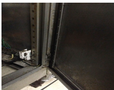
Figura 3 - Falta de aterramento entre porta e painel Fonte: o autor, 2015
