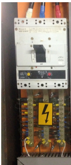
Figura 7 - Proteção de partes energizadas Fonte: o autor, 2015
