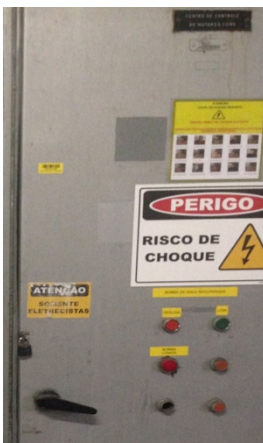
Figura 6 - Identificação de restrição no painel elétrico Fonte: o autor, 2015
