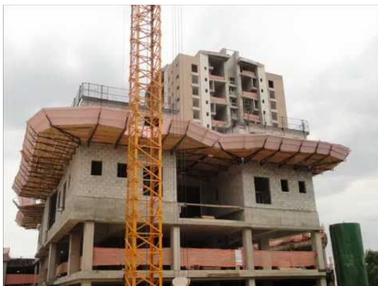
Figura 7 - Plataforma de Proteção
