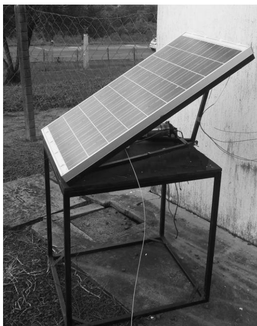
Figura 22 – Painel fotovoltaico instalado Fonte: Autoria própria
