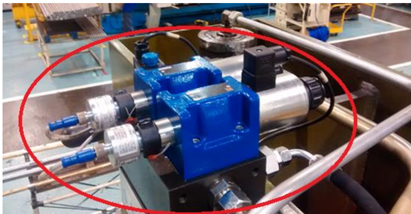
Figura 17 – Detalhe do bloco hidráulico de segurança. Fonte: Laudo de adequação da empresa que realizou a adequação.
