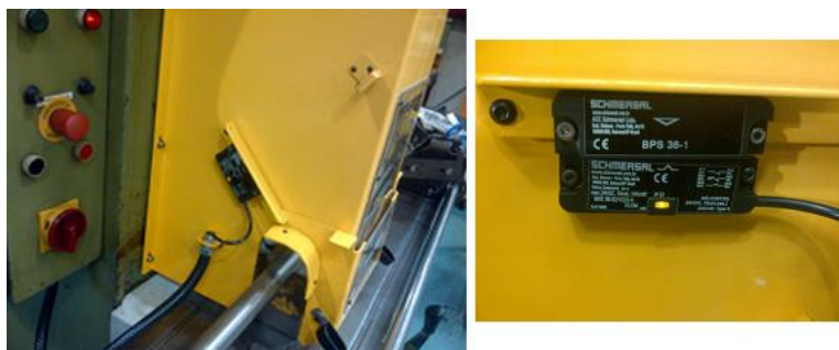
Figura 15 – Detalhe da chave magnética monitorada. Fonte: Laudo de adequação da empresa que realizou a adequação.
