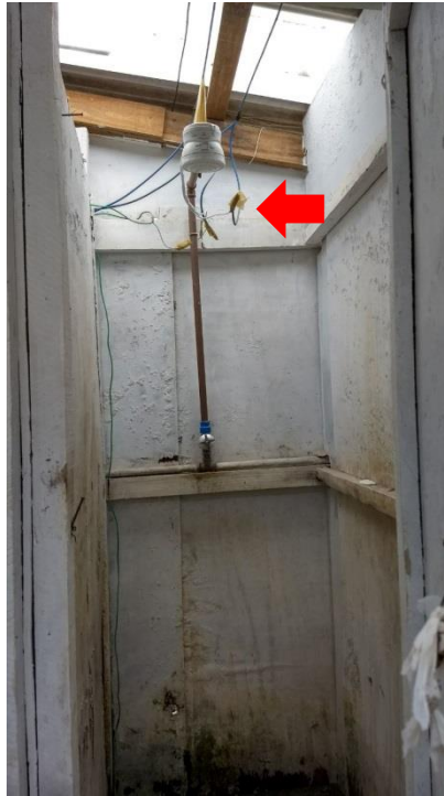
Figura 27: Obra C. Chuveiro com instalações elétricas precárias Fonte: A autora (2017).
