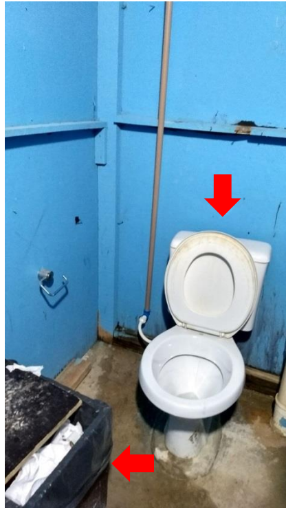
Figura 17: Obra A. Lixeira com tampa e vaso sanitário com caixa acoplada Fonte: A autora (2017).
