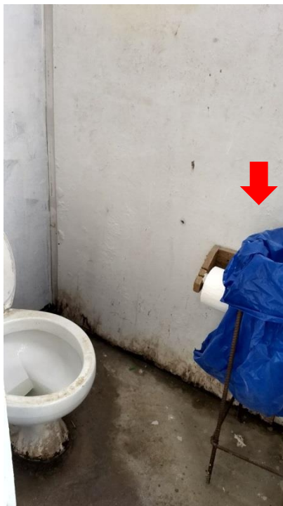
Figura 20: Obra C. Lixeira sem tampa Fonte: A autora (2017).
