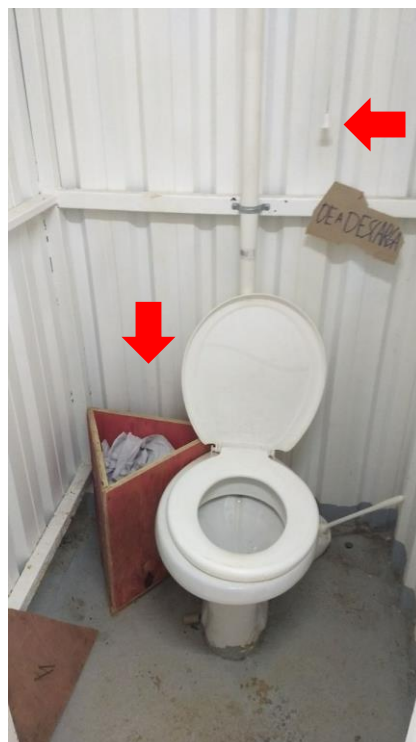
Figura 18: Obra B. Lixeira com a tampa no chão e vaso sanitário com caixa de descarga provida de puxador. Fonte a autora (2017).
