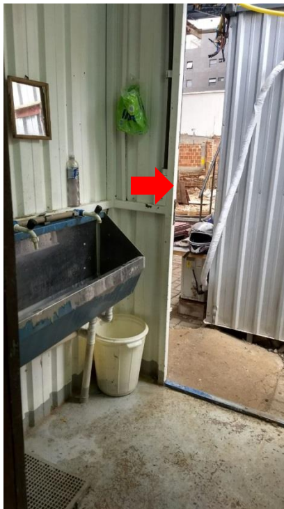
Figura 15: Obra B. Abertura para iluminação e ventilação lavatórios Fonte: A autora (2017).
