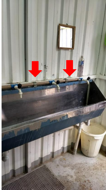
Figura 14: Obra B. Lavatório com espaçamento entre torneiras inferior a 0,60m Fonte: A autora (2017).
