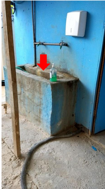
Figura 12: Obra A. Lavatório sem revestimento interno liso Fonte: A autora (2017).
