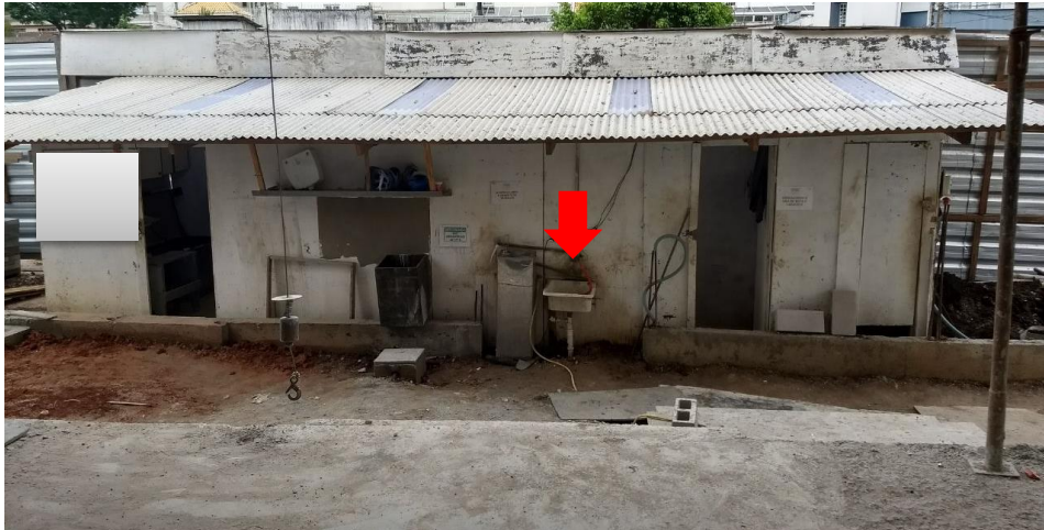
Figura 16: Obra C. Lavatório com altura inferior a 0,90m
