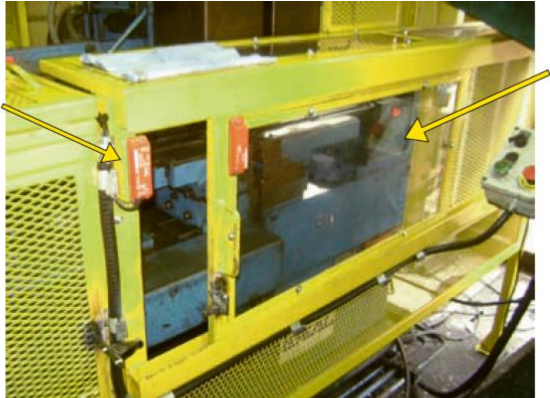
Figura 8 - Proteção móvel com intertravamento na posição aberta Fonte: ABIMAQ 2012.
