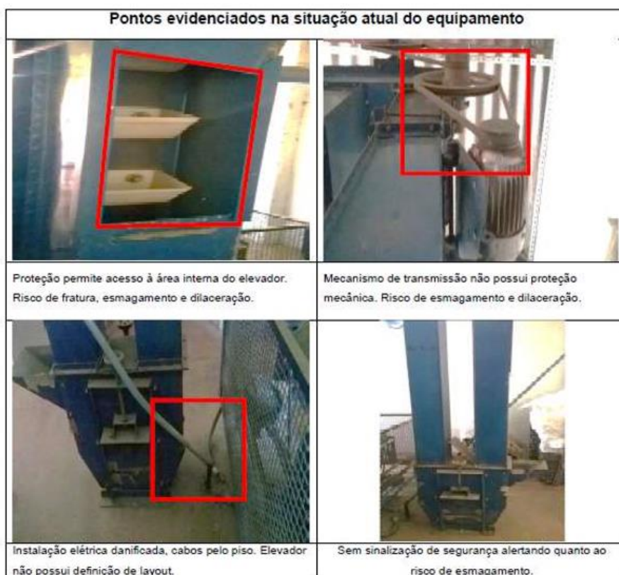
Figura 6 - Itens em Desconformidade Elevador de Canecas I
