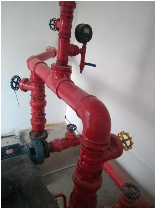
Figura 16 Conjunto de válvulas do sistema de combate a incêndio Fonte: A Autora, 2018.
