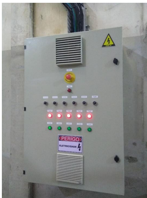
Figura 14 Painel elétrico de automação do Sistema de exaustão Fonte: A Autora, 2018.
