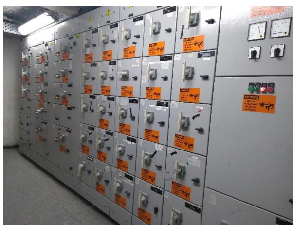
Figura 11 Comando Central de Motores Fonte: A Autora, 2018.
