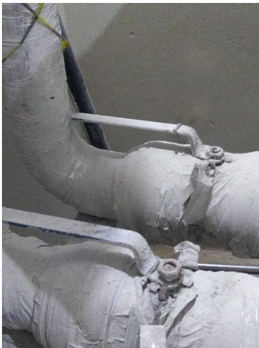
Figura 17 Válvulas do Sistema de resfriamento Fonte: A Autora, 2018.
