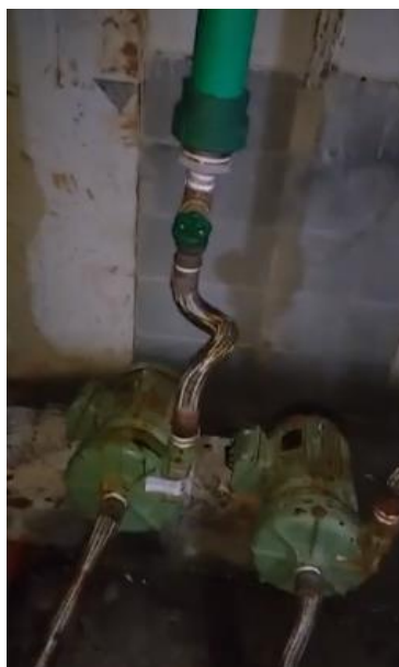
Figura 37 – Bombas de recalque Fonte: O Autor (2018).
