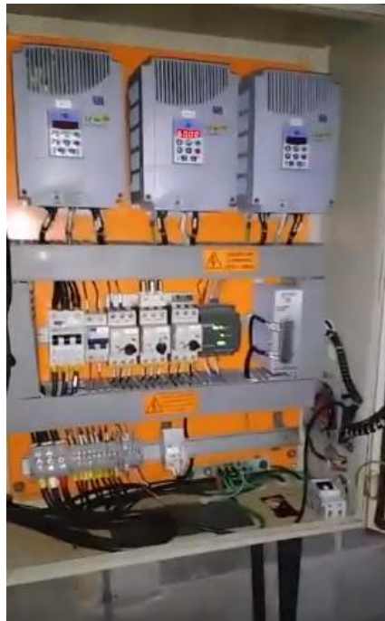
Figura 38 – Painel de Comando de bomba Fonte: O Autor (2018).
