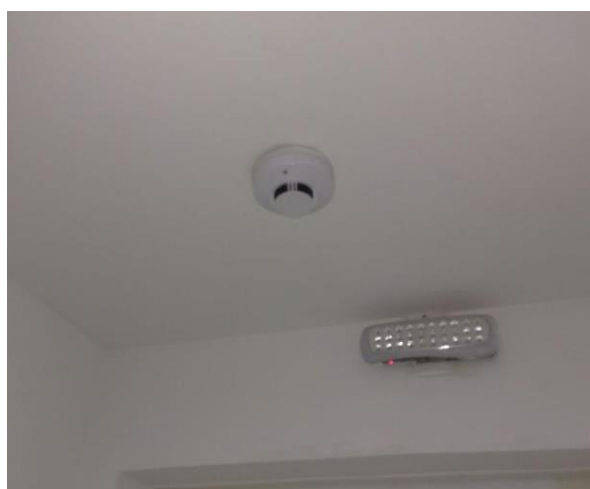
Figura 32 – Detector de Fumaça Óptico Fonte: O Autor (2018).
