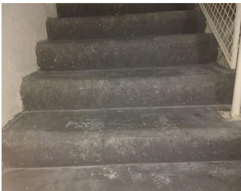
Figura 27 – Irregularidade nos degraus
