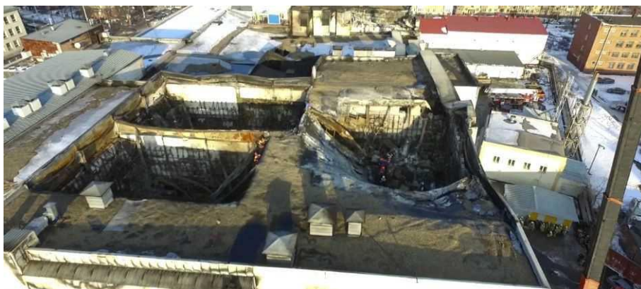
Figura 11 – Revestimento da Fachada Queimando Fonte: Site Diário do Grande ABC. 2018.
