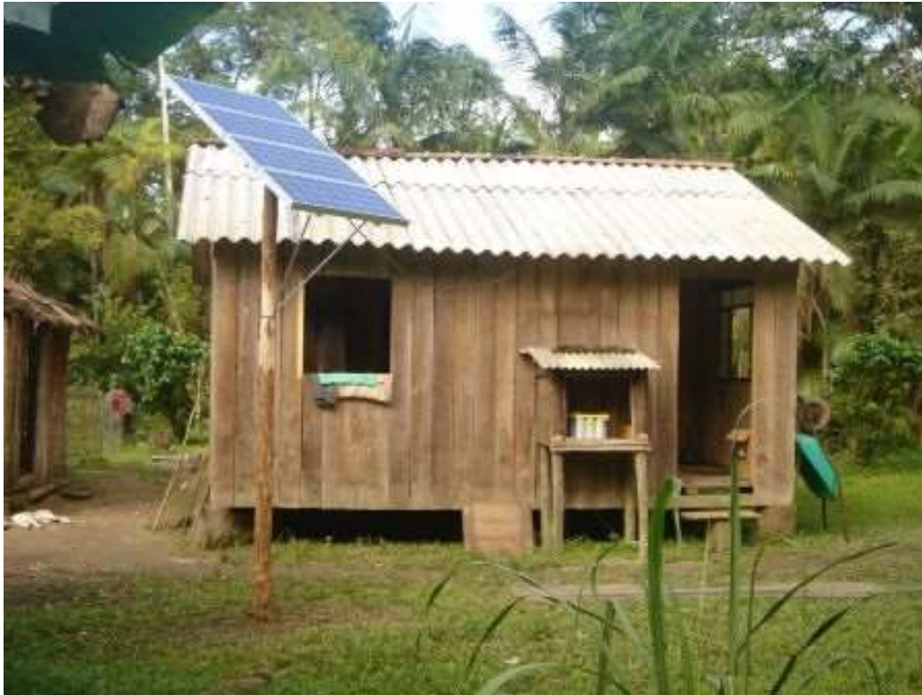
Figura 8 - Sistema fotovoltaico isolado em comunidades distantes
