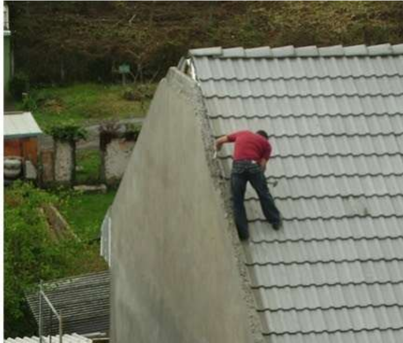
Figura 9 - Trabalhador em ato inseguro. Risco iminente de acidente.
