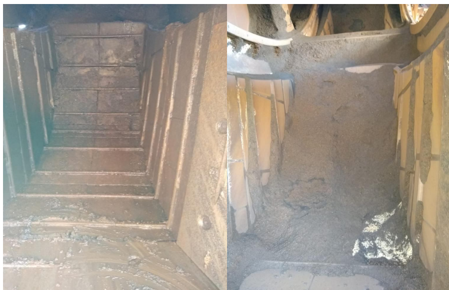
Figura 1.8. Roda de caçamba do SR-3 limpa e após alguns minutos em operação, ilustrando a dificuldade de escoamento do material.
