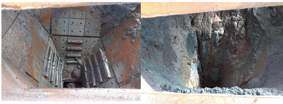
Figura 1.9. Calha do SR-3 limpa e após alguns minutos em operação, ilustrando a dificuldade de escoamento do material.
