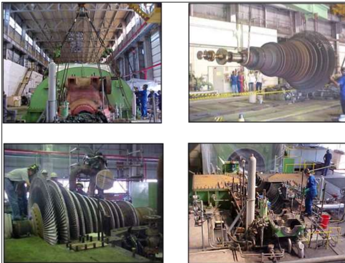
Figura 2 – Turbina 03 da ArcelorMittal Tubarão
