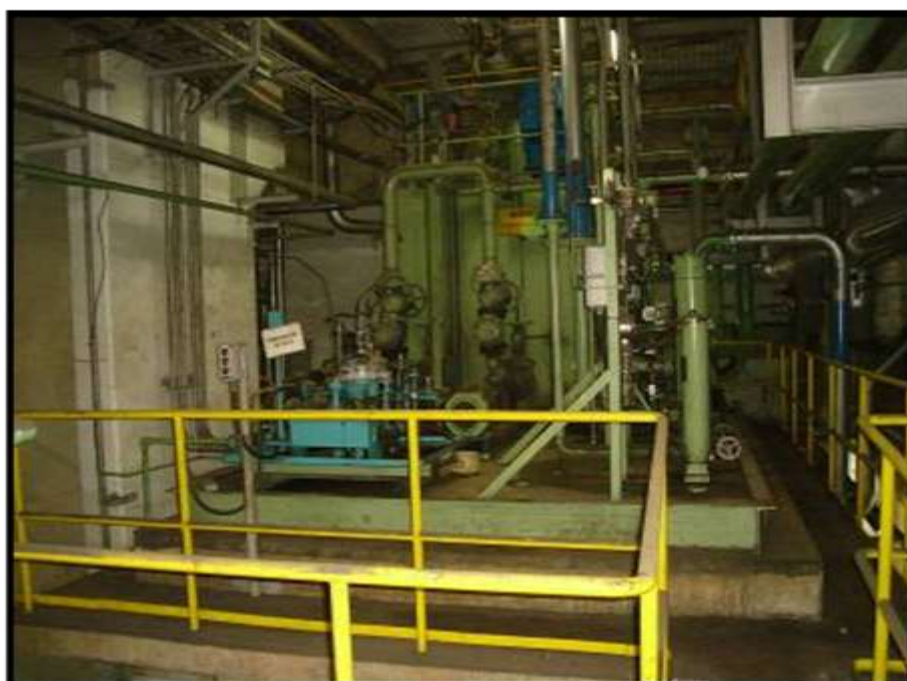
Figura 3 – Tanque de óleo Turbo gerador 03
