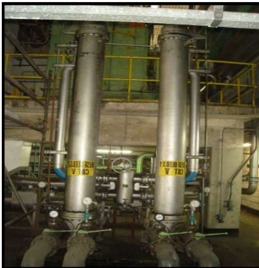
Figura 5 – Resfriadores de óleo
