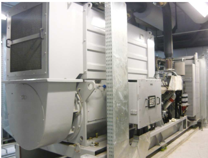
Figura 14 - Foto de Vista Típica do Gerador Fonte: Autoria própria
