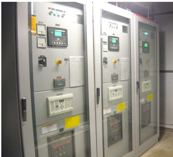
Figura 15 - Foto do Painel de Controle dos Geradores G1, G2 e G3 Fonte: Autoria própria
