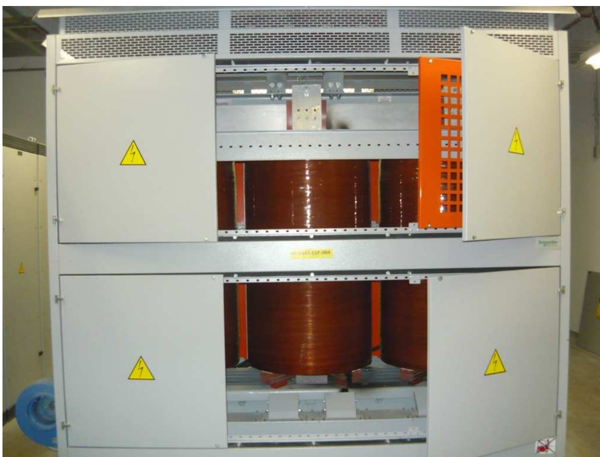
Figura 12 - Foto do Transformador com as Tampas de Proteção Abertas Fonte: Autoria própria
