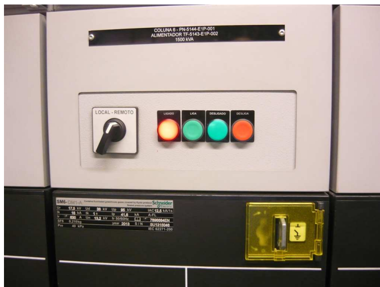
Figura 10 - Foto do Sistema de Controle Típico de Alta Tensão Fonte: Autoria própria
