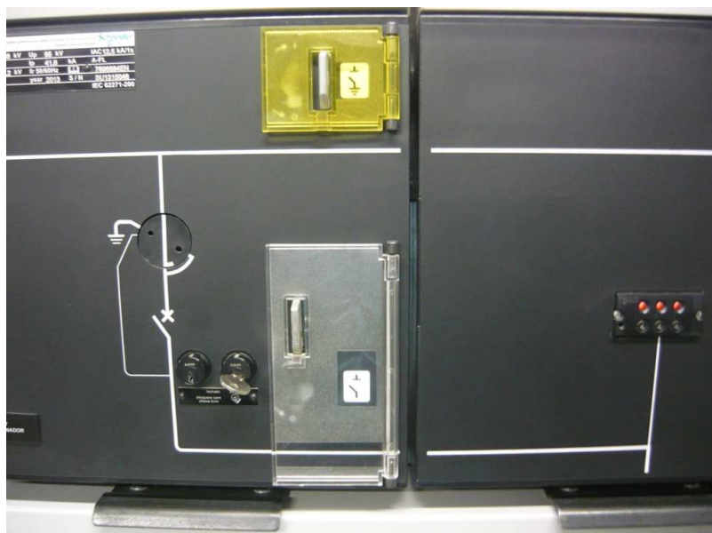
Figura 9 - Foto do Comando da Seccionadora Típica de Alta Tensão Fonte: Autoria própria
