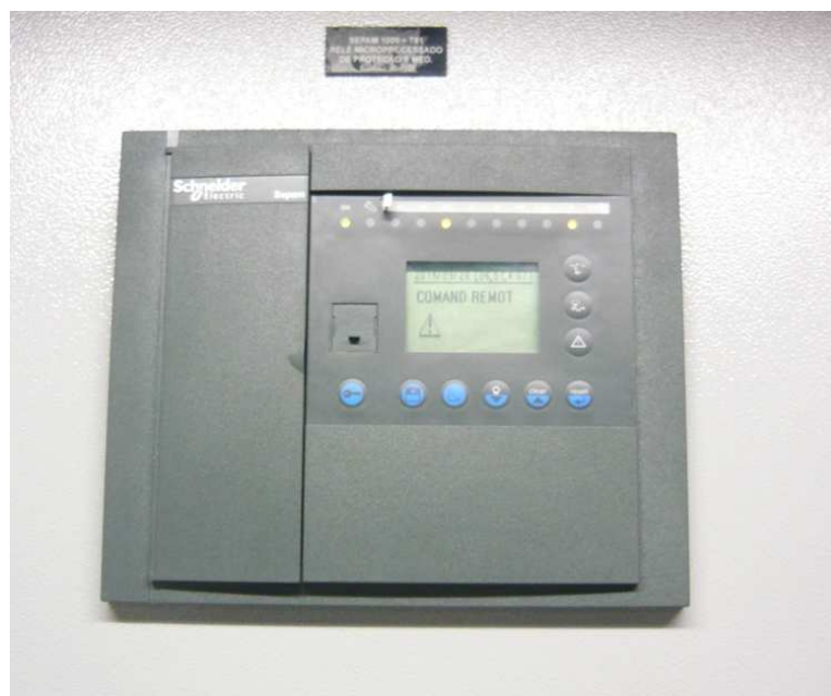
Figura 11 - Foto do Sistema de Proteção Típico de Alta Tensão Fonte: Autoria própria
