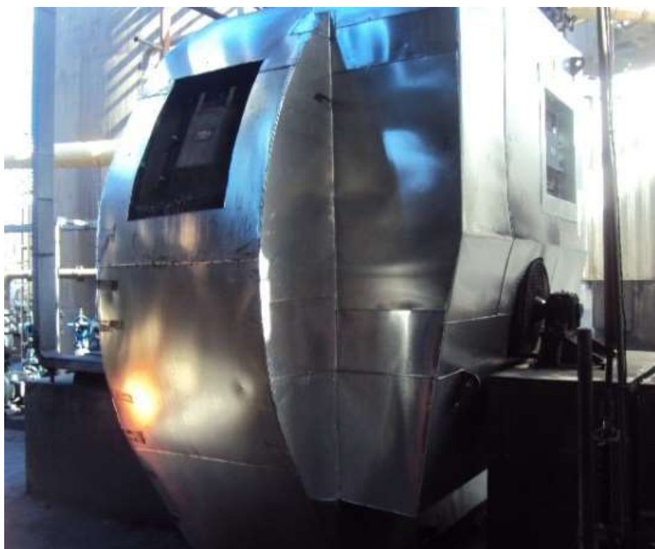
Figura 4 – Foto do exaustor tiragem caldeira.
