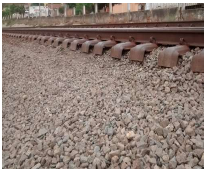
Fotografia 4 – Lastro de brita insuficiente
