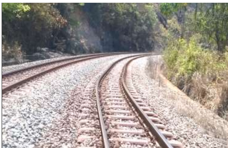
Fotografia 1 – Flambagem na ferrovia
