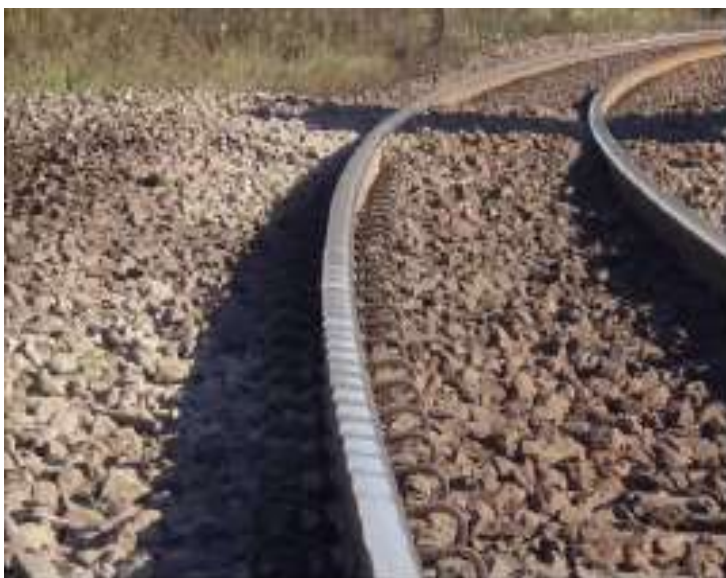
Fotografia 3 – Defeitos superficiais em Trilhos
