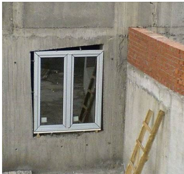
Figura 9 – Caixaria executada desnivelada Fonte: Rodrigues (2014).
