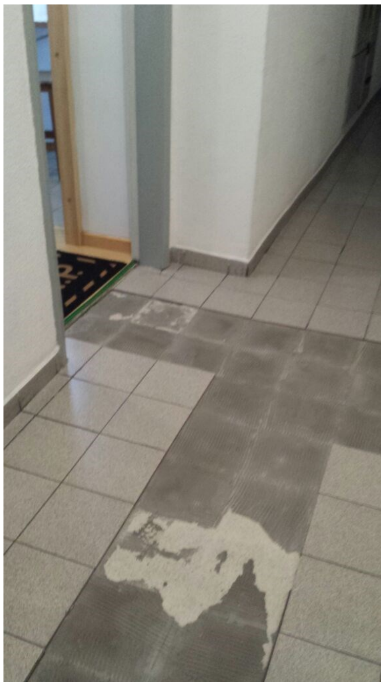
Figura 7 - Descolamento de Cerâmicas Fonte: a autora (2017).
