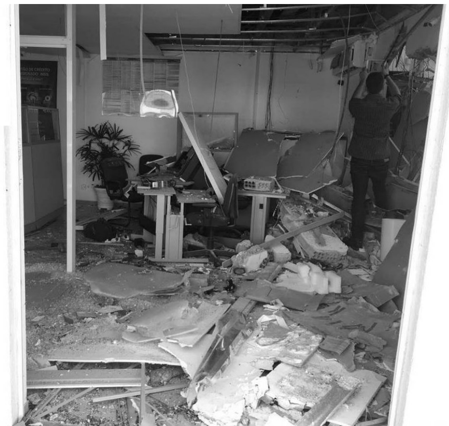
Figura 21 - Banco "Y" após explosão Fonte: a autora (2017)
