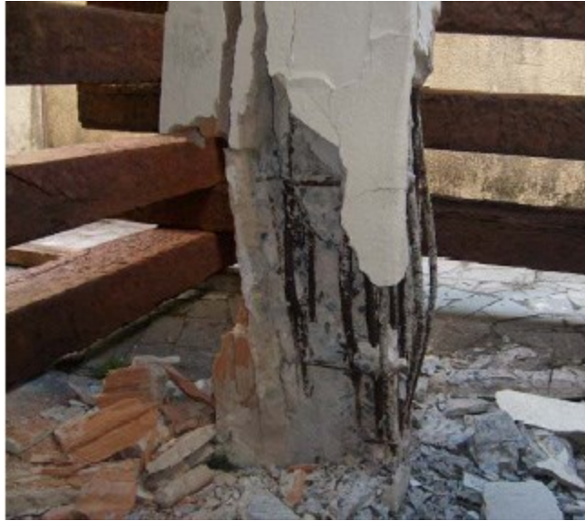
Figura 14: Pilar com Flambagem Fonte: Camargo (2011).
