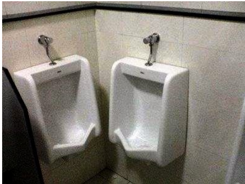
Figura 12: Erro de Execução Fonte: Sou mais minha casa (2010).
