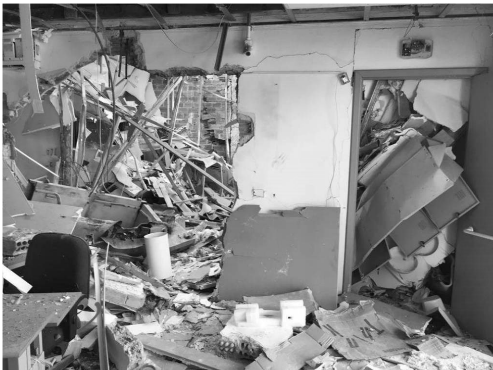
Figura 20 - Banco "Y" após explosão Fonte: a autora (2017)
