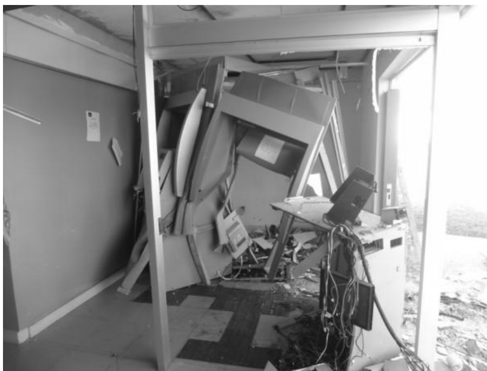
Figura 25 - Banco "W" caixas automáticos após explosão Fonte: a autora (2016).
