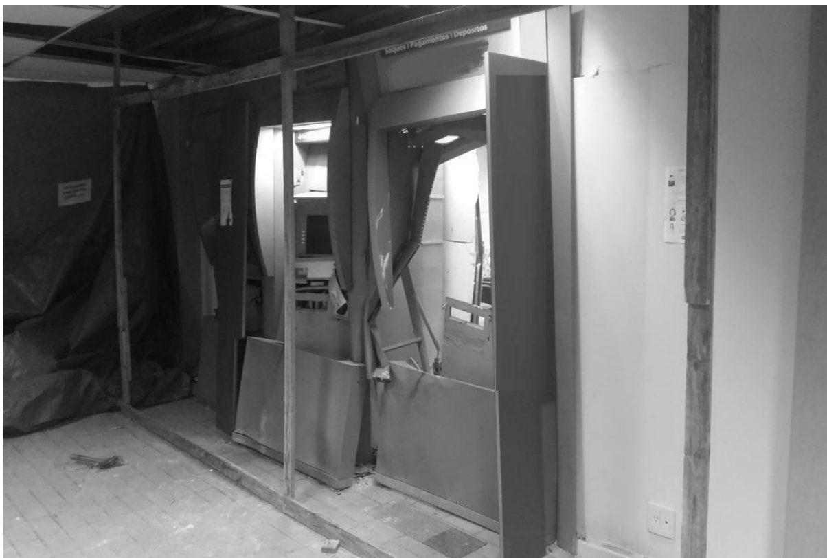
Figura 22 - Banco "Z" afetado por explosão - saguão fábrica Fonte: a autora (2016)
