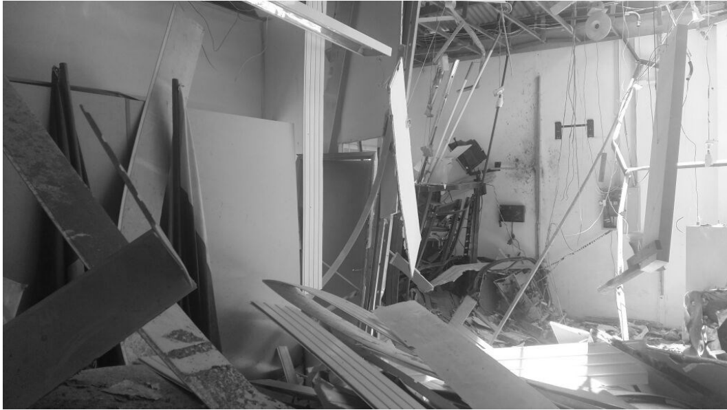
Figura 17 - Banco "X" após vandalismo Fonte: a autora (2017).
