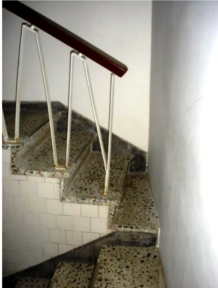
Figura 11: Escada má dimensionada Fonte: Rodrigues (2014).
