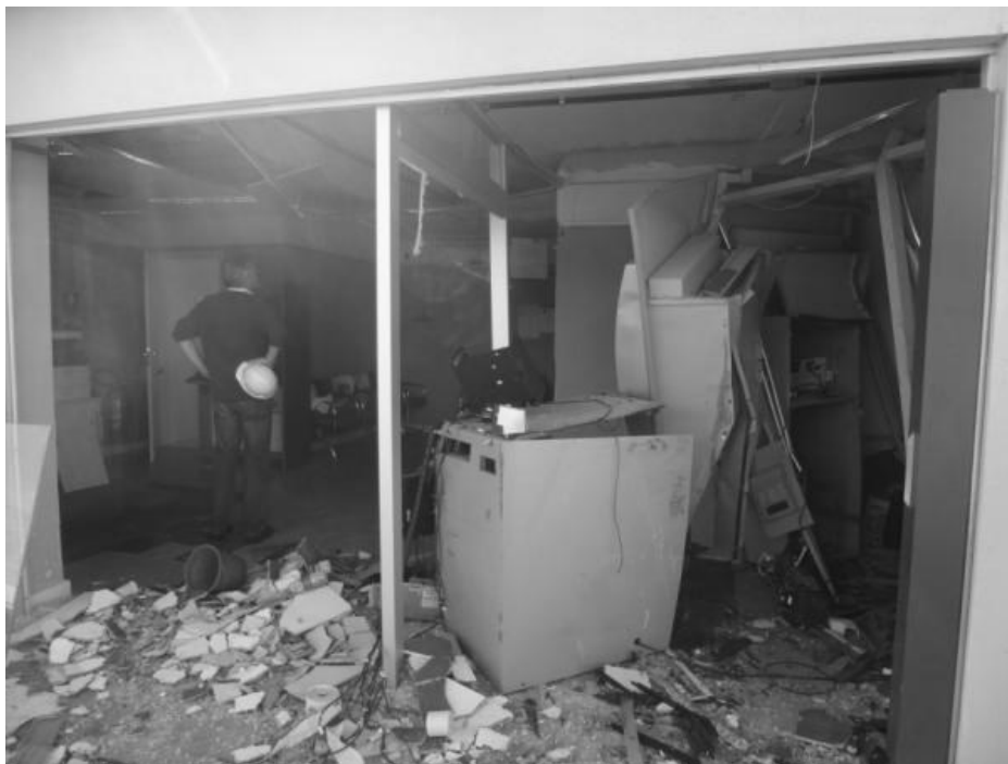
Figura 23 - Banco "W" fachada após explosão Fonte: a autora (2016).
