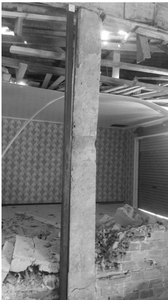
Figura 19 - Pilar danificado, com escora metálica Fonte: a autora (2017)
