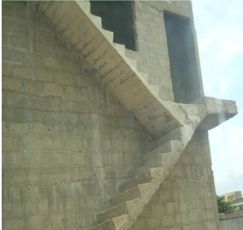
Figura 8: Erro de Execução Fonte: Granja (2010).
