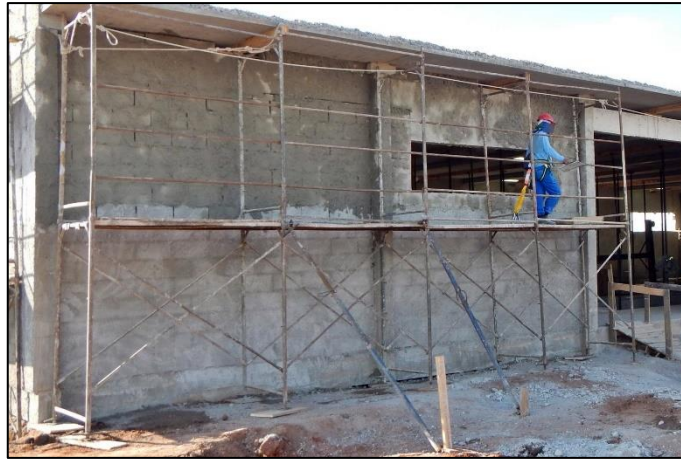
Figura 29 – Andaimes em desacordo com o PCMAT Fonte: Autoria própria (2014)
