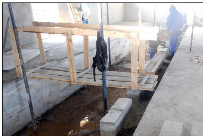
Figura 25 – Passarelas inadequadas Fonte: Aatoria própria (2014)
