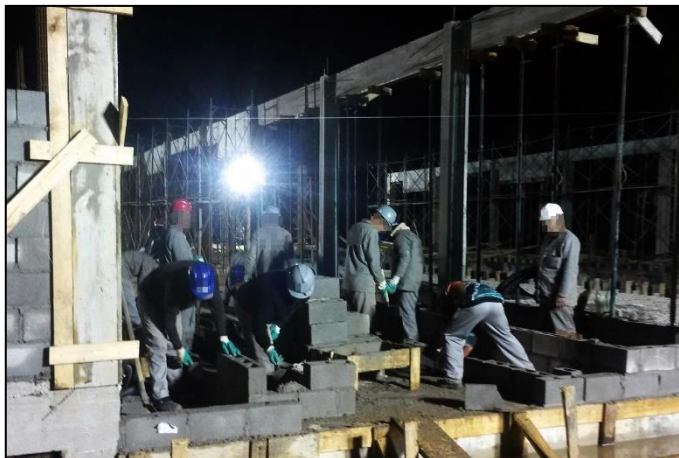
Figura 39 – Atividade noturna com boa iluminação Fonte: Autoria própria (2014)
