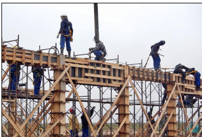
Figura 32 – Trabalhos nas vigas em altura sem linha de vida Fonte: Aatoria própria (2014)
