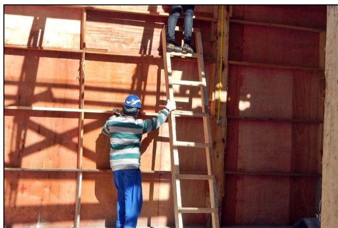
Figura 27 – Escadas impróprias na obra Fonte: Autoria própria (2014)
