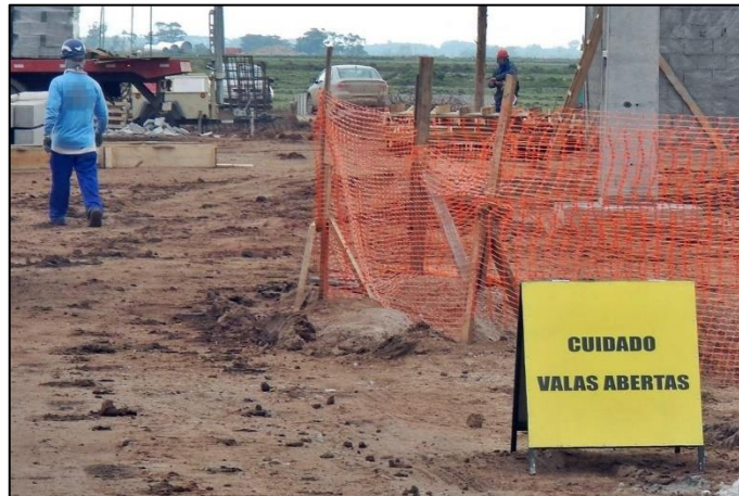
Figura 20 – Poucas sinalizações pela obra Fonte: Aatoria própria (2014)
