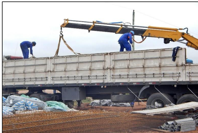
Figura 35 – Falta da linha de vida no descarregamento Fonte: Aatoria própria (2014)
