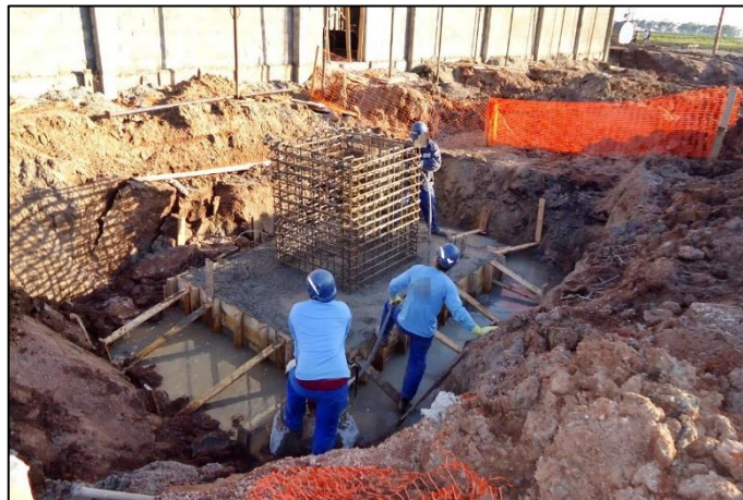
Figura 23 – Escavações sem escada para acesso Fonte: Aatoria própria (2014)
