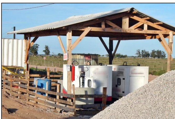
Figura 15 – Gerador de energia elétrica do canteiro Fonte: Autoria própria (2014)
