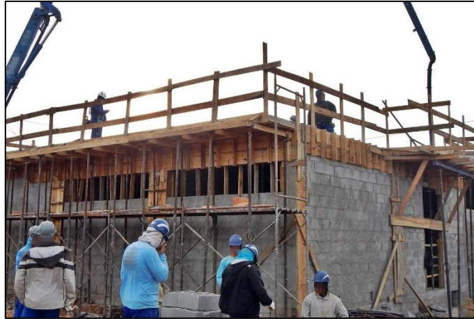
Figura 34 – Guarda corpo para os trabalhos em altura Fonte: Aatoria própria (2014)
