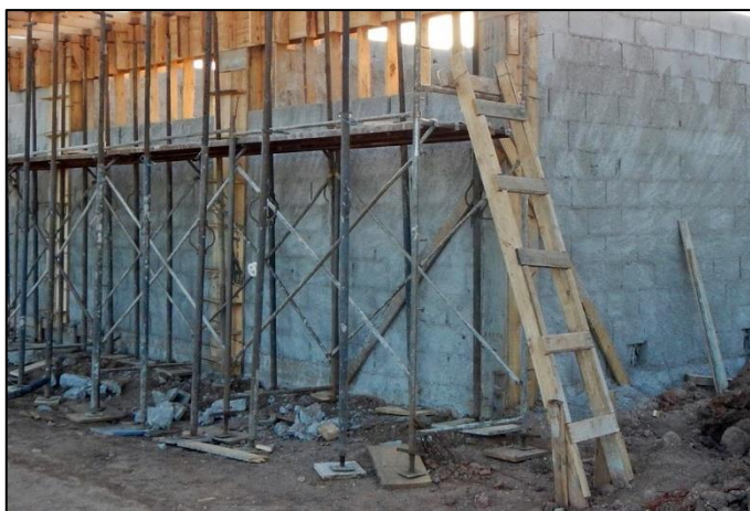
Figura 31 – Acesso improvisado e inadequado para andaime Fonte: Aatoria própria (2014)
