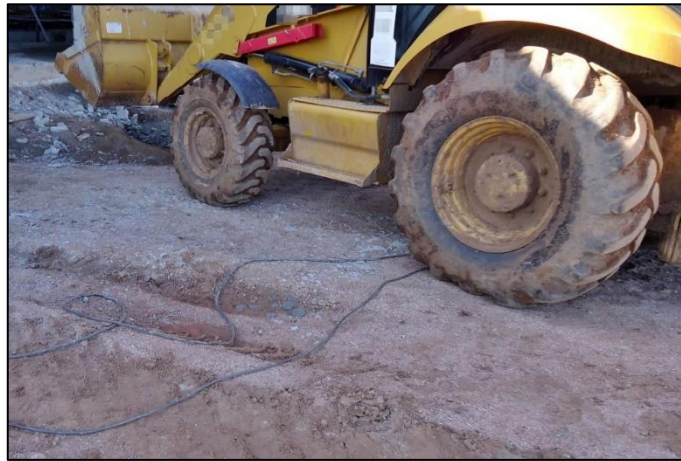
Figura 44 – Fiação elétrica solta pela obra Fonte: Autoria própria (2014)
