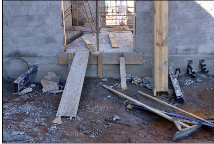
Figura 26 – Rampas improvisadas Fonte: Autoria própria (2014)
