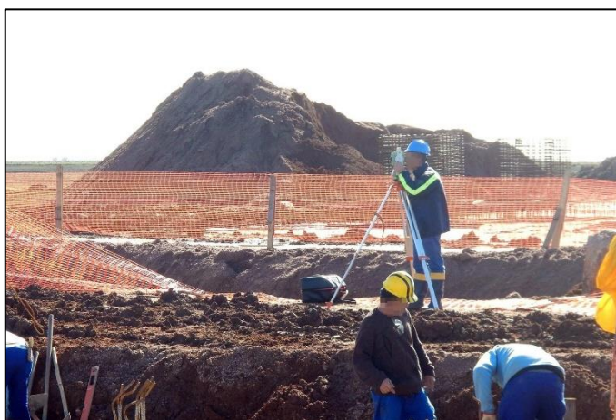
Figura 19 – Trabalhos próximo a escavações sem isolamento Fonte: Aatoria própria (2014)
