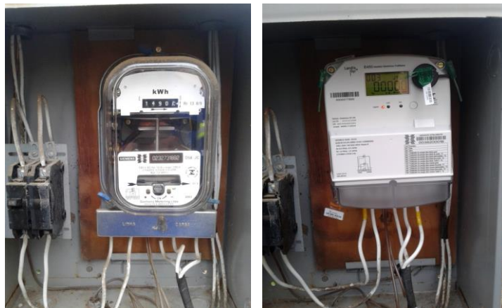
Fotografia 1 – Medidor eletromecânico (esquerda), medidor IoT inteligente (direita)
