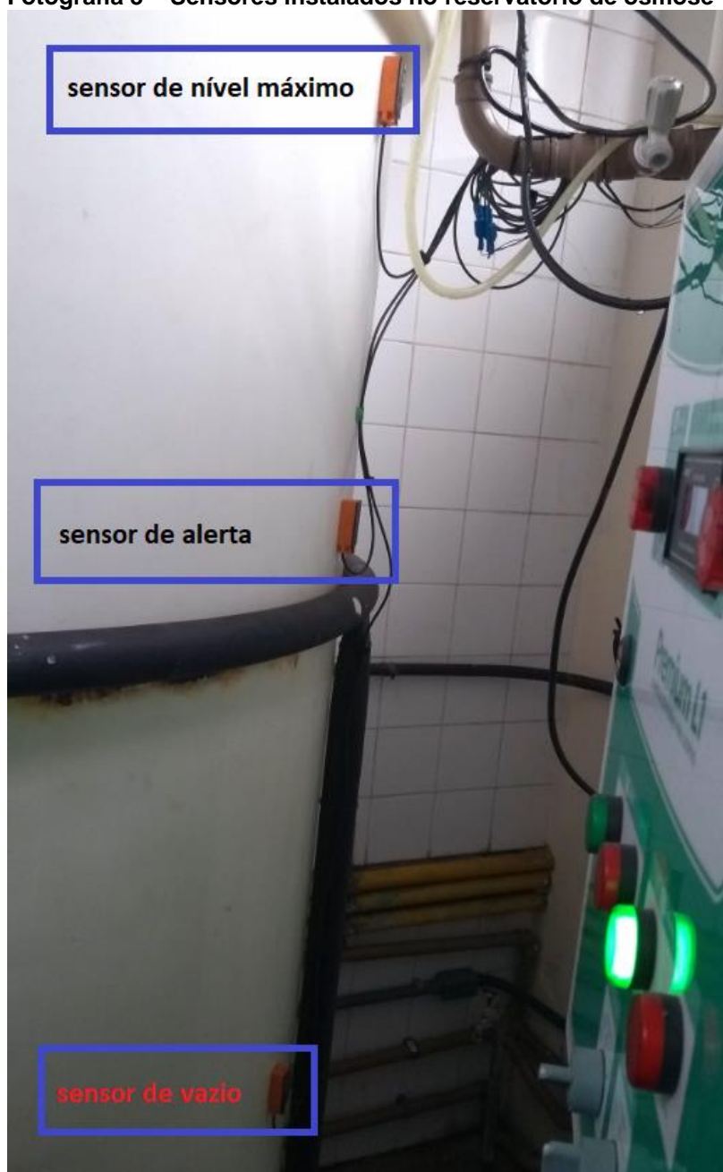
Fotografia 3 – Sensores instalados no reservatório de osmose
