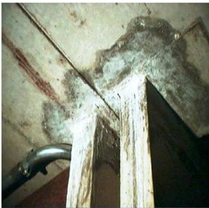
Figura 2 - Processo adiantado de Lixiviação e eflorescências entre pilares e laje em fundo de reservatório de água.
