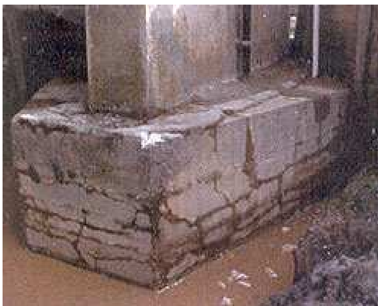
Figura 4 - Reação álcali agregado em fundação de um edifício de múltiplos andares.
