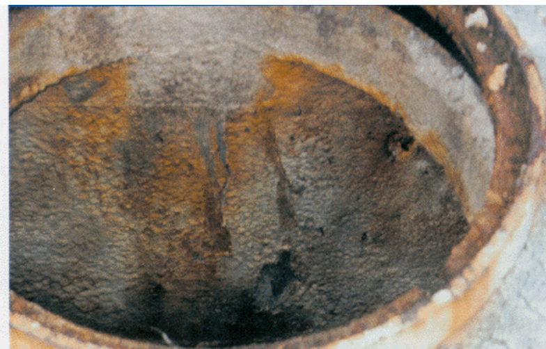
Figura 3 - Ataque por sulfatos em uma tubulação de esgoto.
