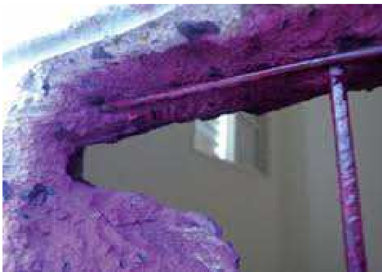
Figura 5 - Aspecto visual de tela de aço carbono (não revestida), com indícios de corrosão, embutida em concreto com ar incorporado. Ensaio com fenolftaleína. Área mais clara mostra a região carbonatada.
