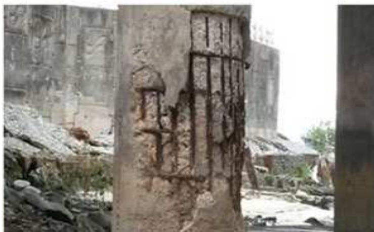
Figura 6 - Pilar sob a ponte do Rio Calhau - São Luiz MA. Deslocamento do concreto em consequência a corrosão das armaduras que sofreram o ataque de íons cloreto. Fonte http://techne.pini.com.br/engenharia-civil/212/artigo332558-2.aspx
