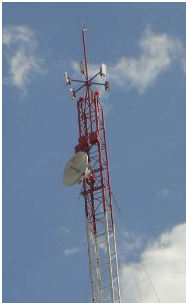
Figura 5 - Estação de telecomunicações com acessos WLAN Fonte: Autoria própria
