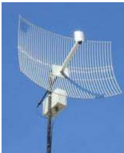
Figura 4 - Sistema de acesso WLAN instalado no assinante Fonte: Autoria própria
