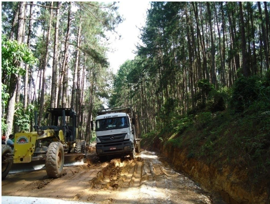
Figura 26 - Caminhão atolado na via de circulação
