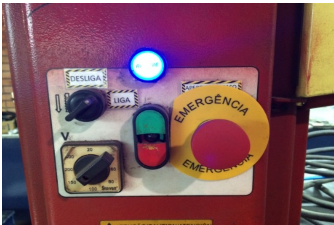
Figura 19 – Detalhe do Painel de acionamento (DEPOIS DA ADEQUAÇÃO)
