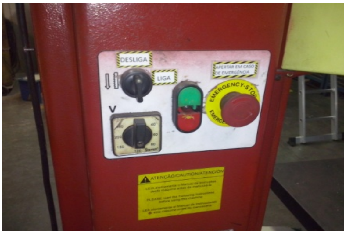
Figura 18 – Detalhe do Painel de acionamento (ANTES DA ADEQUAÇÃO)
