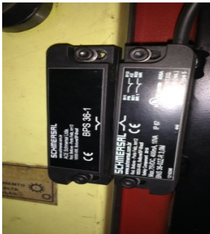
Figura 13 – Imagem Local – Detalhe Sensor Porta de Acesso (DEPOIS DA ADEQUAÇÃO)
