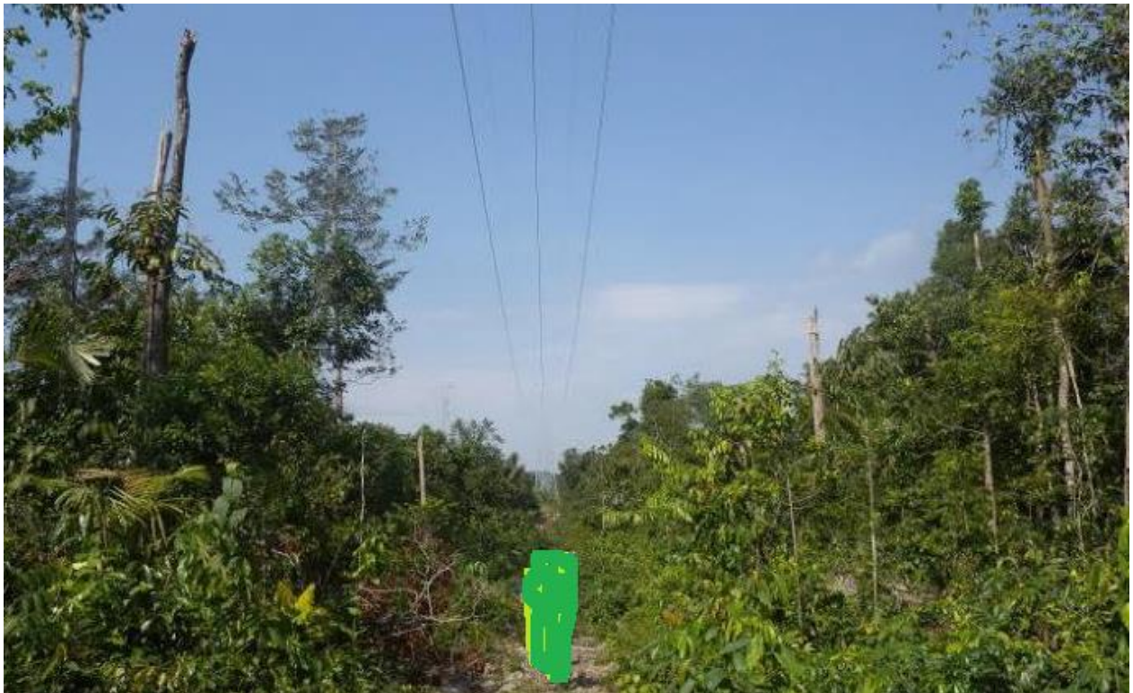
Figura 6 – Rede aérea necessitando roçada de faixa Fonte: Impa.
