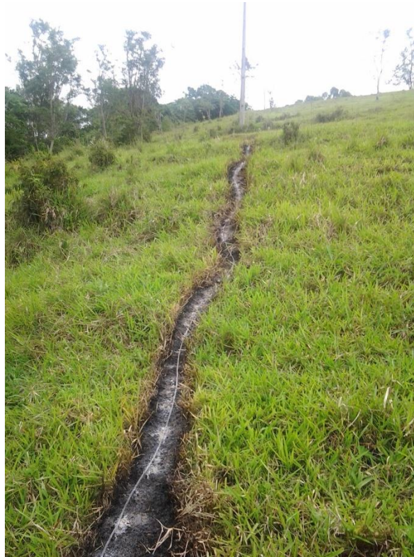
Figura 14 - Cabo rompido energizado no solo Fonte: Autoria própria.
