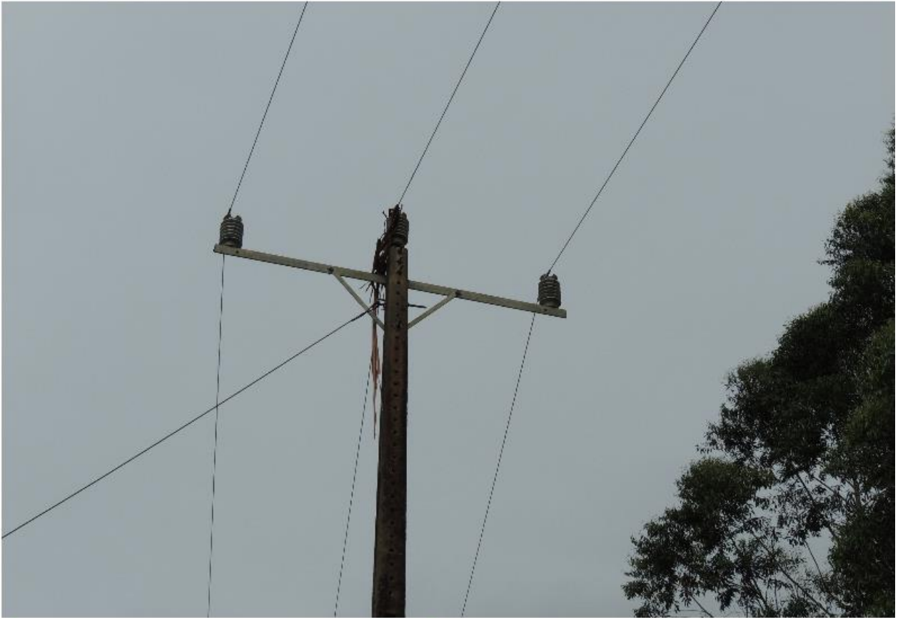
Figura 2 – Casca de eucaliptos na rede elétrica Fonte: Cermissões.
