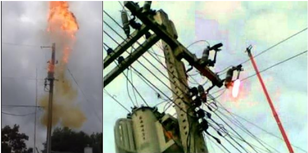
Figura 7 - Explosão de transformador e fechamento de chave fusível Fonte: Autoria própria.
