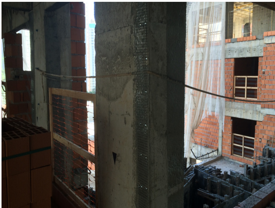
Fotografia 13 – Linhas de vida não externas às estruturas de trabalho na obra “A”.
