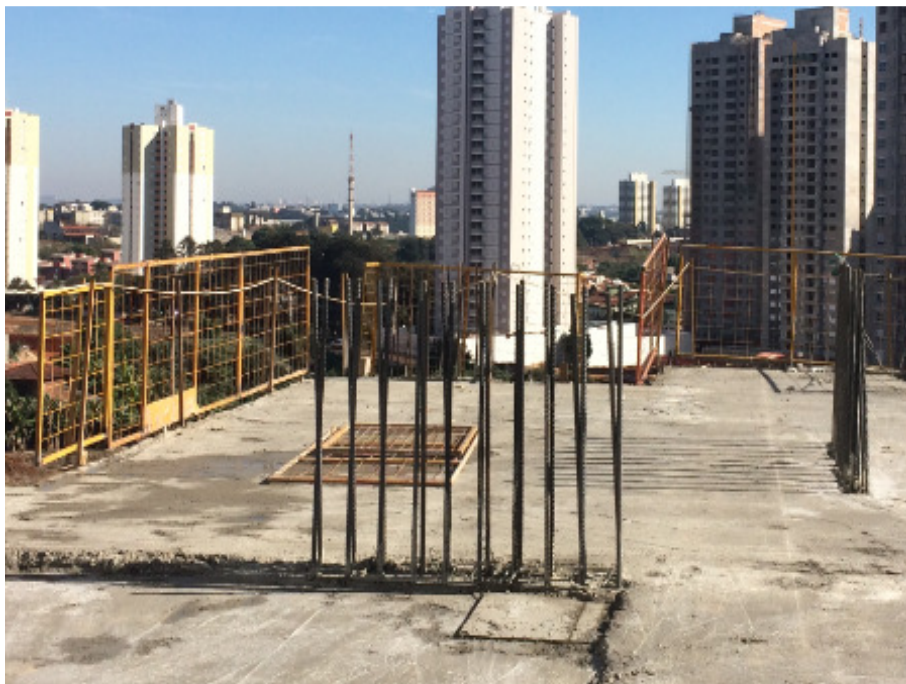
Fotografia 15 – Linhas de vida na obra “A”.
