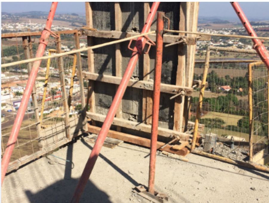
Fotografia 18 – Linhas de vida na obra “B” com altura menor que 1,50m.
