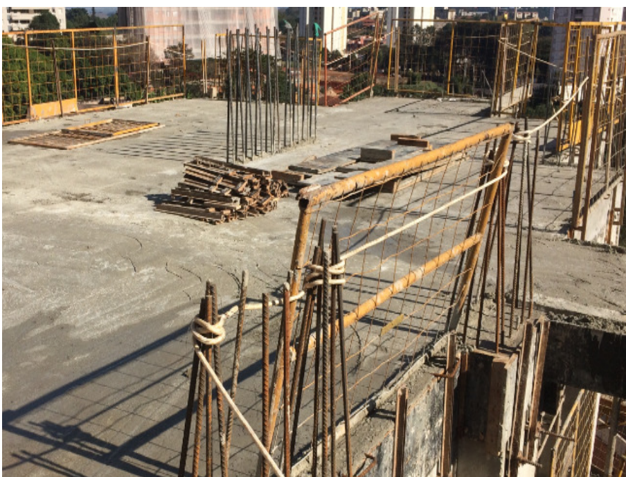
Fotografia 19 – Linhas de vida não externas às estruturas de trabalho na obra “A”.
