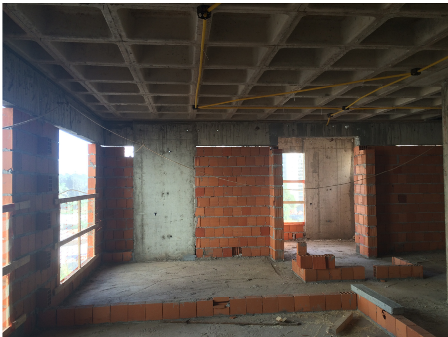
Fotografia 5 – Pontos de ancoragem na obra “A”. Não fixação em paredes de alvenaria. Fonte: Autoria própria.
