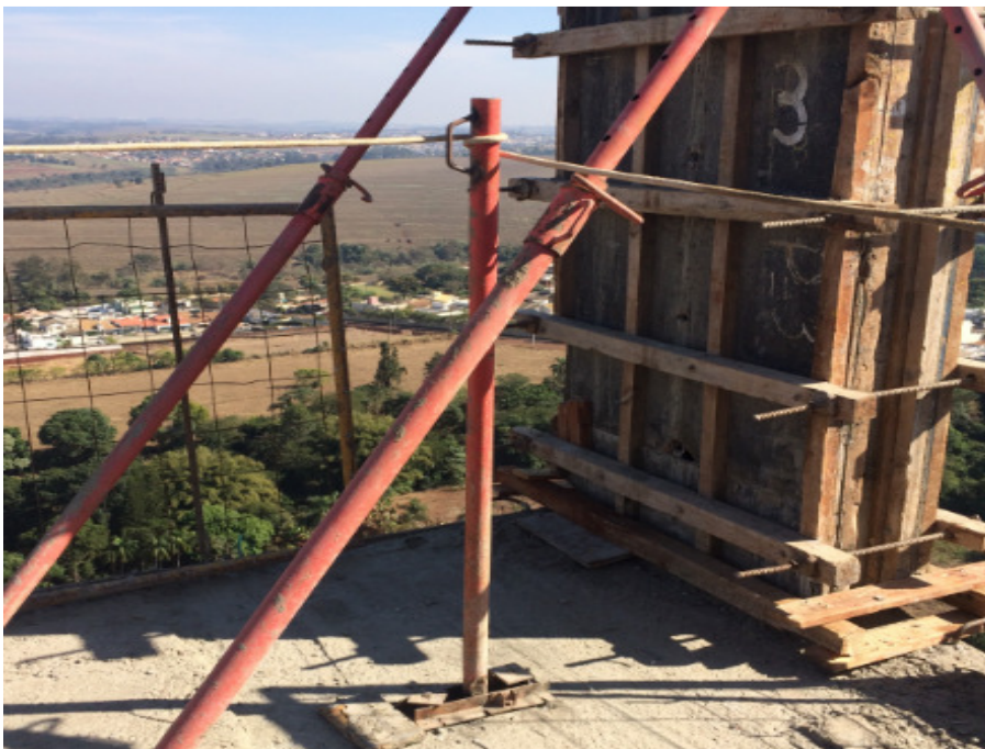
Fotografia 20 – Linhas de vida externas às estruturas de trabalho na obra “A”. Fonte: Autoria própria.
