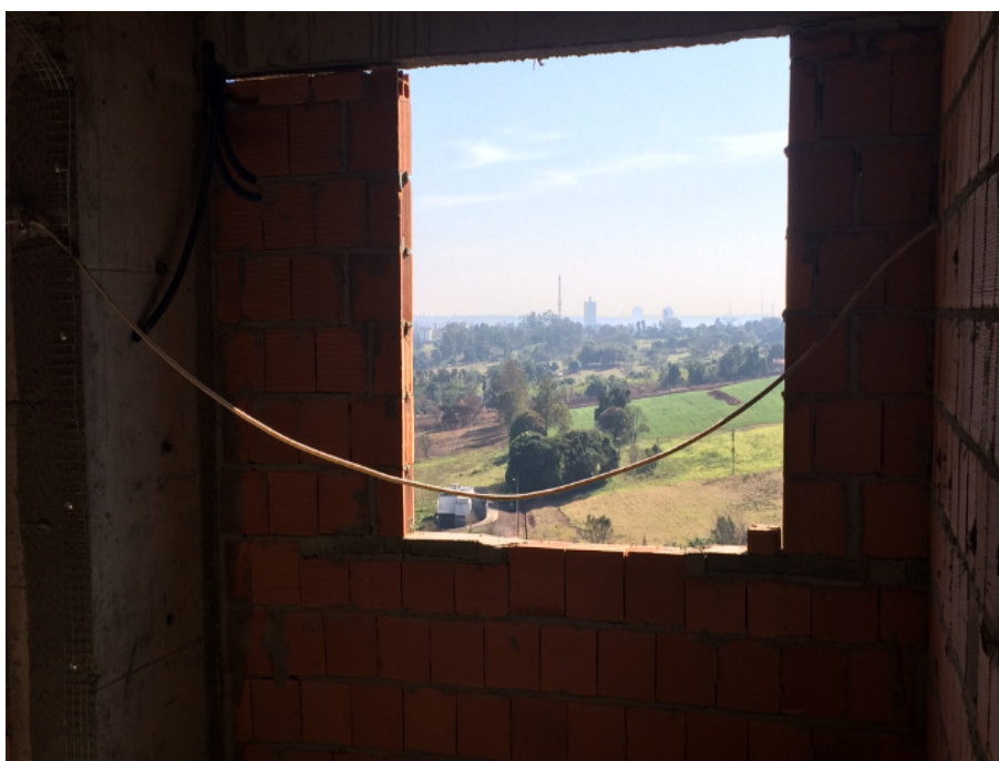
Fotografia 12 – Linhas de vida na obra “B” com altura menor que 1,50m.
