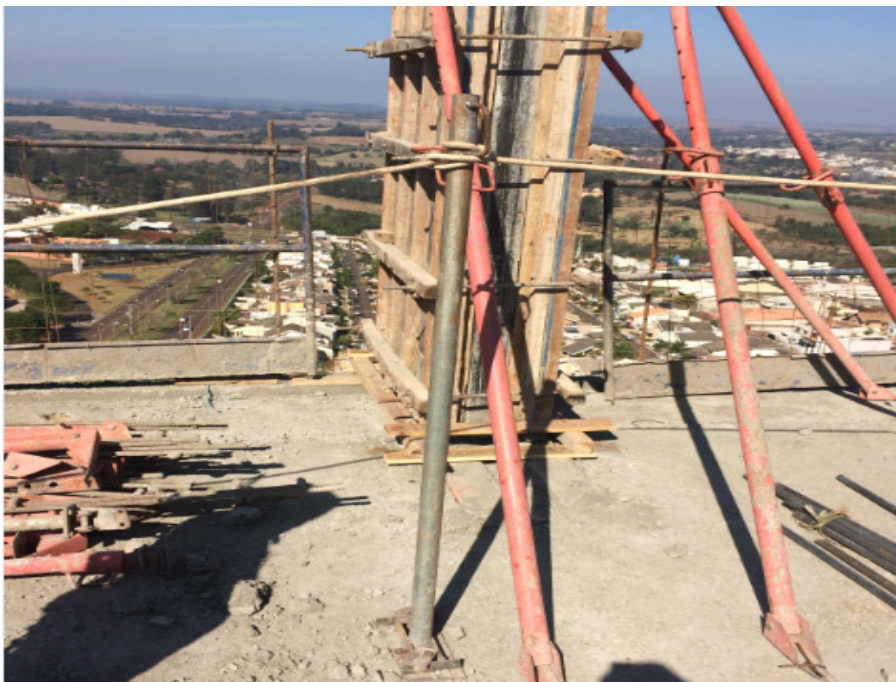
Fotografia 16 – Linhas de vida na obra “B”.
