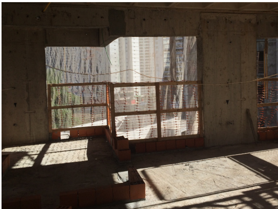
Fotografia 9 – Linhas de vida na obra “A”.
