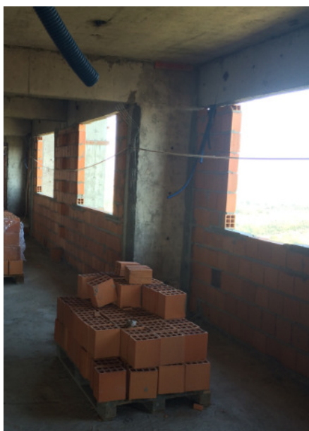
Fotografia 10 – Linhas de vida na obra “B”.
