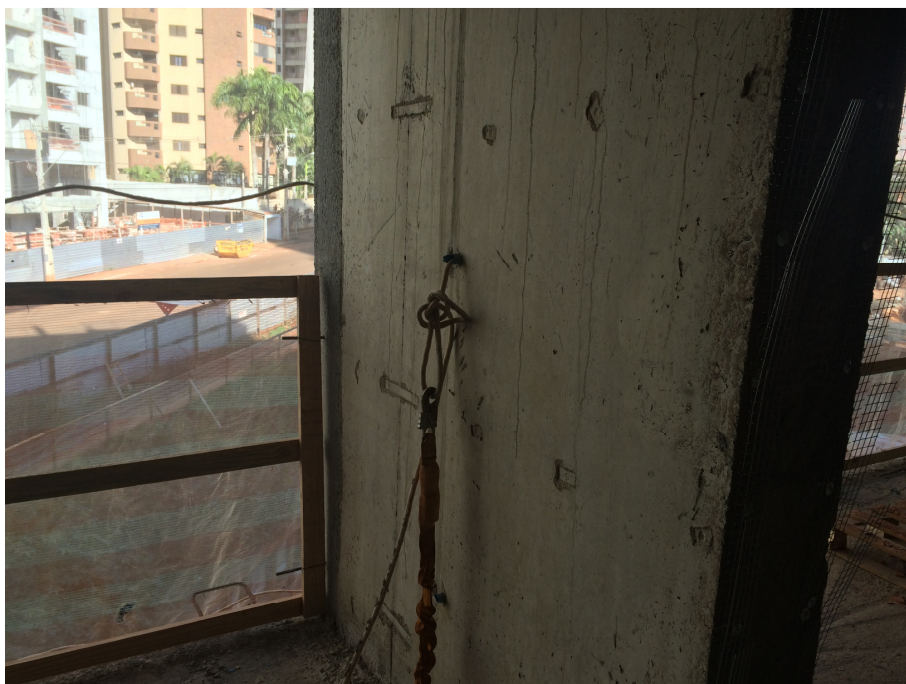
Fotografia 7 – Pontos de ancoragem em estrutura de concreto na obra “A”. Não utilização de parafuso olhal.
