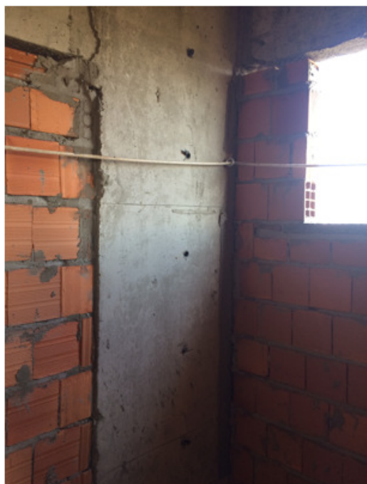
Fotografia 6 – Pontos de ancoragem na obra “B”. Não fixação em paredes de alvenaria. Fonte: Autoria própria.
